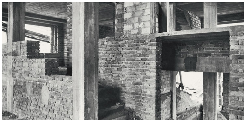
Fig. 13: Villa Müller. Foto de la construcción de muros de ladrillo y estructura de pilares de hormigón en el salón. 1930.
