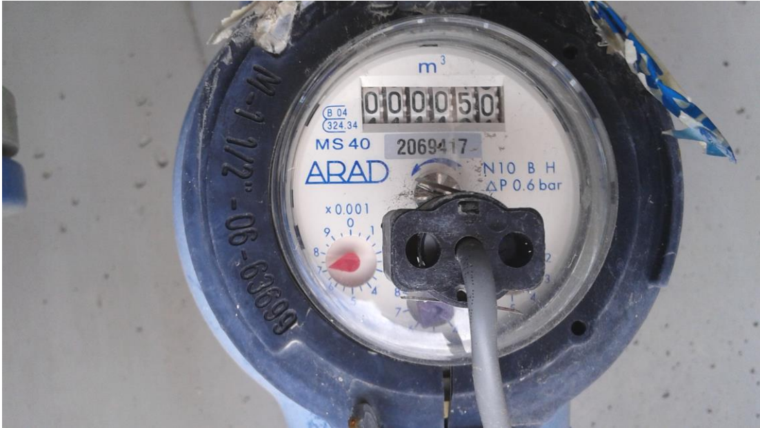
Foto 7.- Contador de la Par.- 750 Pol.11 en hidrante comunitario.
