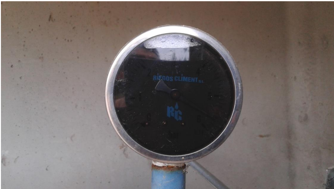
Foto 6.- Manómetro en hidrante comunitario. Presión en carga de 5,6 bar.
