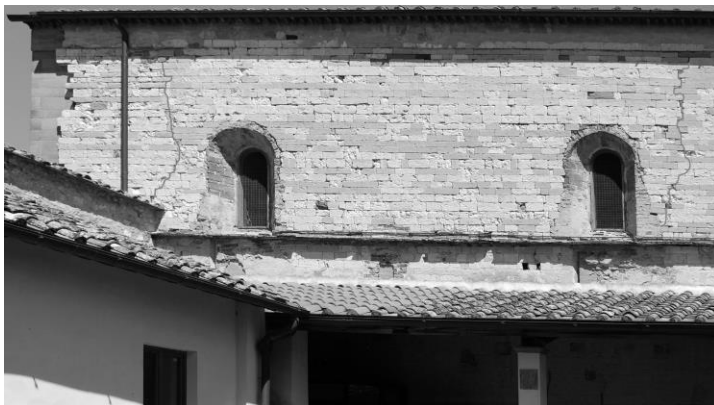
Figure 4. Il prospetto sud della Pieve di Sant'Agata del Mugello. Su questo lato sono ben evidenti due lesioni verticali che ripercorrono l'intero prospetto e che passano molto vicine, ma non coinvolgono, ad alcune aperture costruite agli inizi del Seicento.
