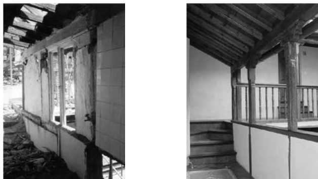
Figuras 3 y 4. Galería antes y después de la actuación con liberación y eliminación del cegado.A.C.S.G.
