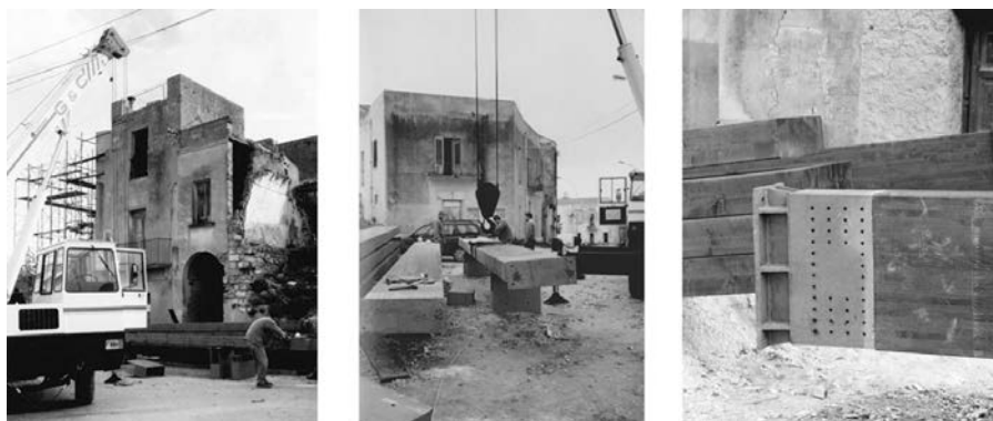
Figure 2-4. Immagini del cantiere di restauro, piloni di legno lamellare e particolare degli elementi metallici di connessione alle fondazioni
