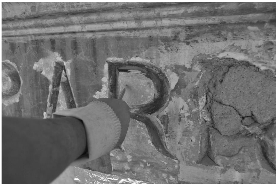
Figura 4. Napoli, Chiesa di San Gennaro all'Olmo. Il ritrovamento dell'iscrizione "Parrocchia all'Olmo" sul prospetto principale, ricoperta da strati recenti di tinteggiatura. Foto M. Villani (2011)
