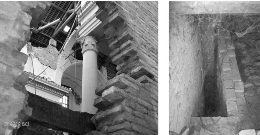
Figura 2. A sinistra: in evidenza particolare della sezione della muratura laterale; a destra: uno dei cavedi situati lungo la muratura perimetrale (Foto Ing. Pongiluppi)
