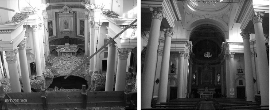
Figura 1. A sinistra: vista d'insieme della chiesa ripresa dalla finestra di facciata in seguito all'evento sismico; a destra: vista d'insieme della chiesa dal portone d'ingresso prima del sisma. (Foto Ing. Pongiluppi)
