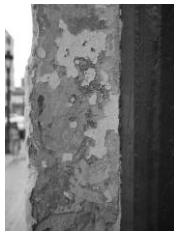
Figura 4. Jamba en planta baja
