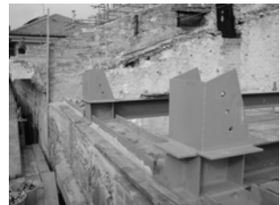
Figura 4. Cordolo metallico e cuffie di collegamento per le capriate lignee della copertura di palazzo Mari a L'Aquila
