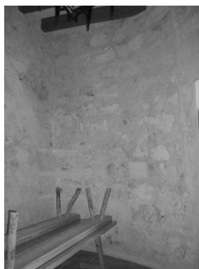
Figura 5. Interior de la Torre de Son Ganxo, acondicionada como centro de encuentro social .
