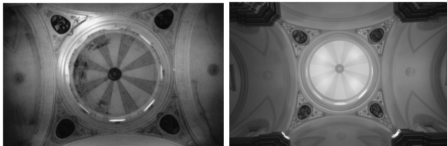
Figura 6. Imagen izquierda: Estado de la cúpula del crucero antes de su intervención en 1997). Fuente: Joaquín López Davó. Imagen derecha: Estado actual de la cúpula del crucero. Fuente: propia.
