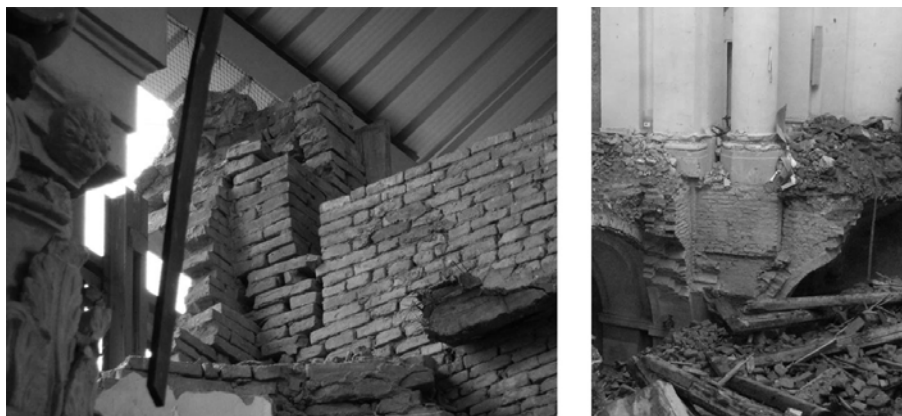
Figura 3. A sinistra: particolare della parete laterale destra; risulta in evidenza l'accostamento di diverse murature prive di ammorsature; a destra: particolare della base del pilastro dove si è verificato lo sfondamento del solaio della cripta; la porzione di muratura sottostante il pilastro è priva di collegamento con le strutture adiacenti. (Foto Ing. Pongiluppi)
