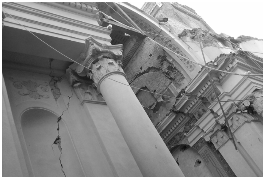
Figura 4. In primo piano: lesioni di un paramento murario e lo scorrimento della colonna sotto il capitello; in secondo piano: la parete destra del presbiterio evidenzia le aperture prima celate (Foto Ing. Pongiluppi)
