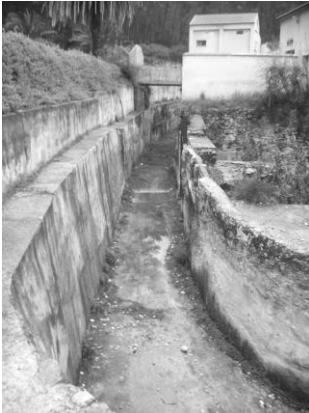
Figura 5. Conducción del agua
