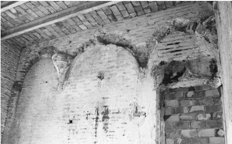
Figura 3. Improntas y restos de los arranques de la bóveda.
