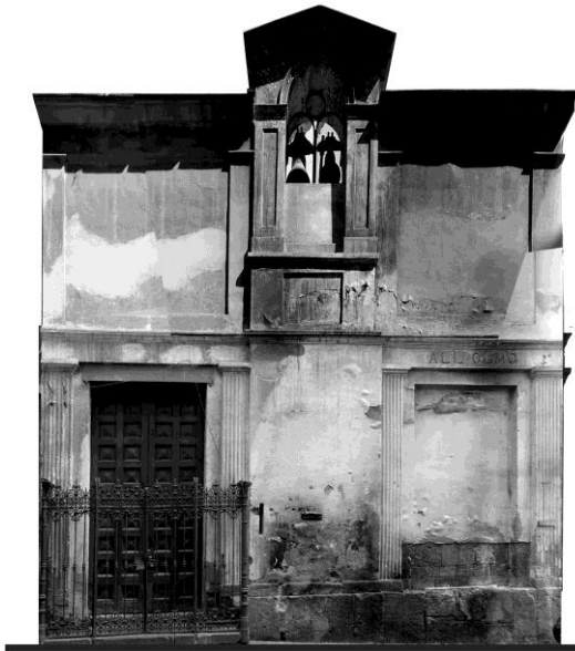
Figura 3. Napoli, Chiesa di San Gennaro all'Olmo. Fotoraddrizzamento del prospetto principale prima del restauro da cui evince l'avanzato stato di degrado delle superfici a seguito dell'incendio. Disegno estratto dal progetto esecutivo a cura dell' arch. M.Villani, 2011
