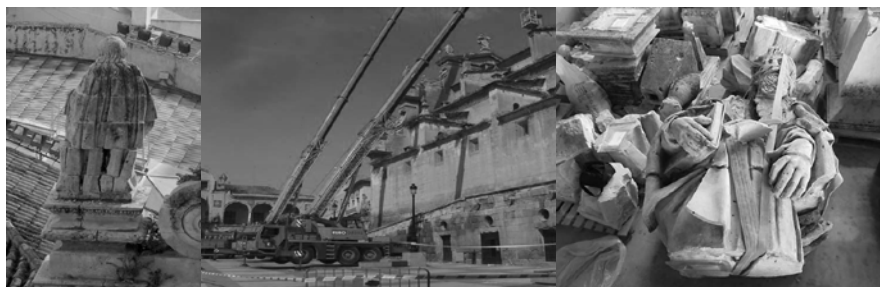
Figuras 5, 6 y 7. Detección de patologías en los elementos decorativos de la fachada principal de la colegiata. Acciones de emergencia con desmontaje de la escultura. Catalogación y protección de las piezas de la escultura en almacén para su posterior restauración, montaje y recolocación in situ . Propiedad de Lorquimur y del Servicio de Patrimonio Histórico de Murcia
