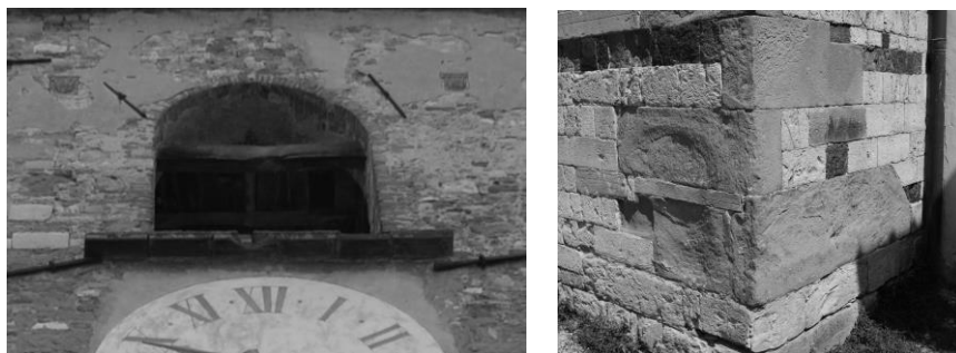
Figure 5. Presidi antisismici riscontrati durante l'analisi della chiesa: la cerchiatura lignea della cella campanaria messa in opera agli inizi del XVII secolo e le catene angolari in pietra serena inserite nella seconda fase costruttiva (probabilmente riferibile al XIII secolo).
