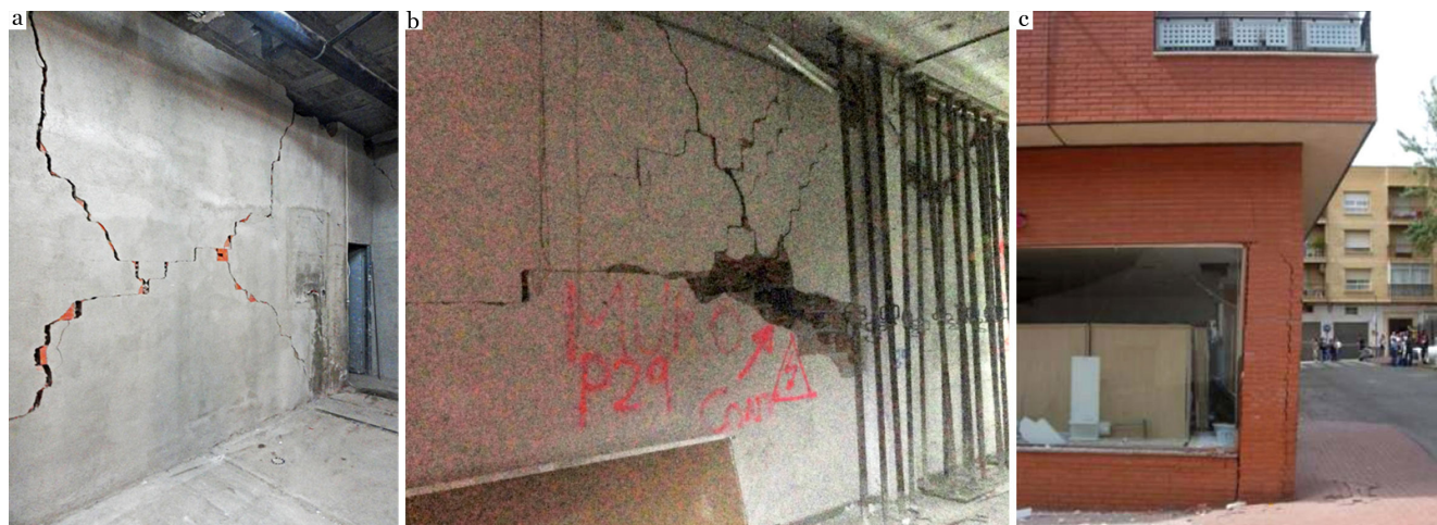
Figura 5. Daño no estructural en tabiquería (DS2 o DS3): por fisuración diagonal (a) y por deslizamiento (b); y mecanismo de planta débil o blanda (DS4) (c).
