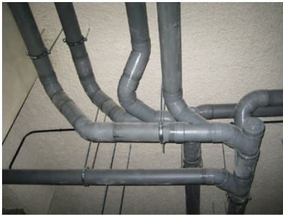
Imagen 15. Tuberías de PVC.
