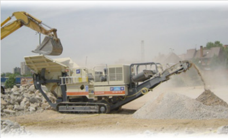
Imagen 19. Planta de procesamiento de áridos reciclados Fuente: www.áridosreciclad.com
