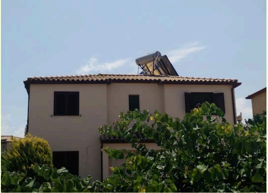
Imagen 35. Panel solar térmico con acumulador. Fuente: fotografía tomada por el autor
