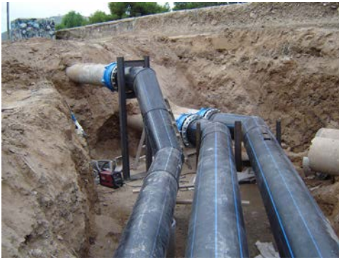
Imagen 14. Tuberías de Polietileno.
