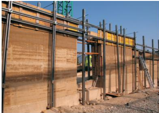
Ilustración 70. Encofrado para la construcción de los tapiales de la bodega Lanciego (Álava).2011. La tapia en España .Técnicas actuales y ejemplos
