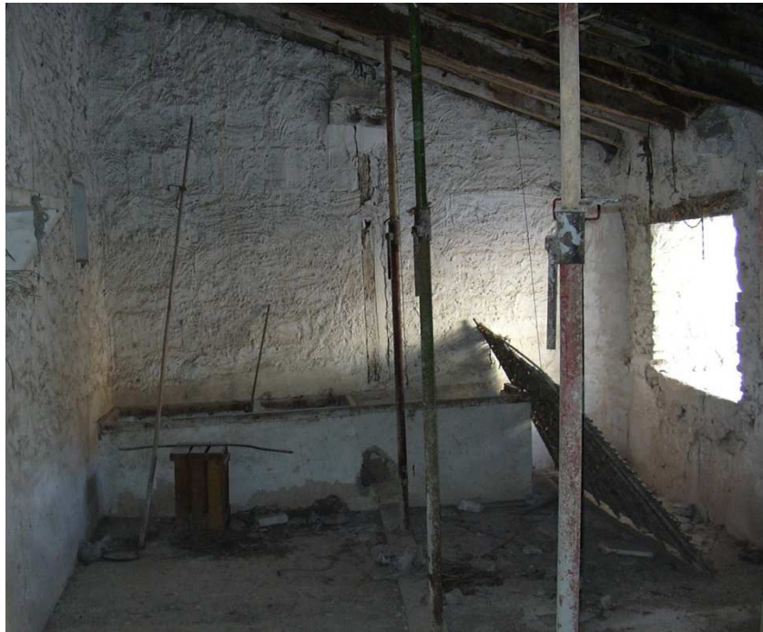
Figura 12. Estado de la planta de cubierta apuntalada a la mitad del paño. Propiedad del arquitecto municipal.
