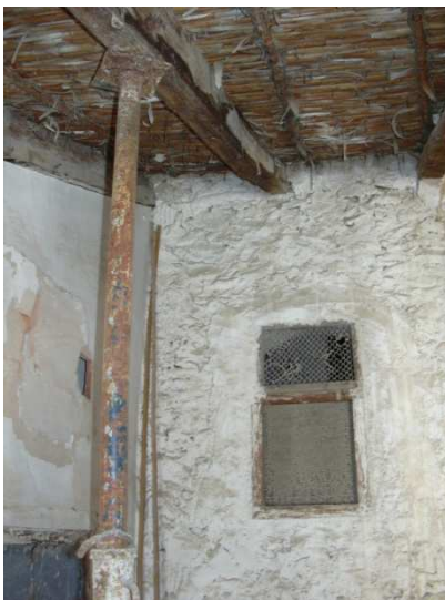
Figura 53. Cubierta con viguetas humedecidas y apuntaladas. Fuente: Arquitecto municipal
