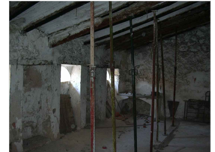
7. Planta segunda apuntalada por mal estado de la cubierta.
