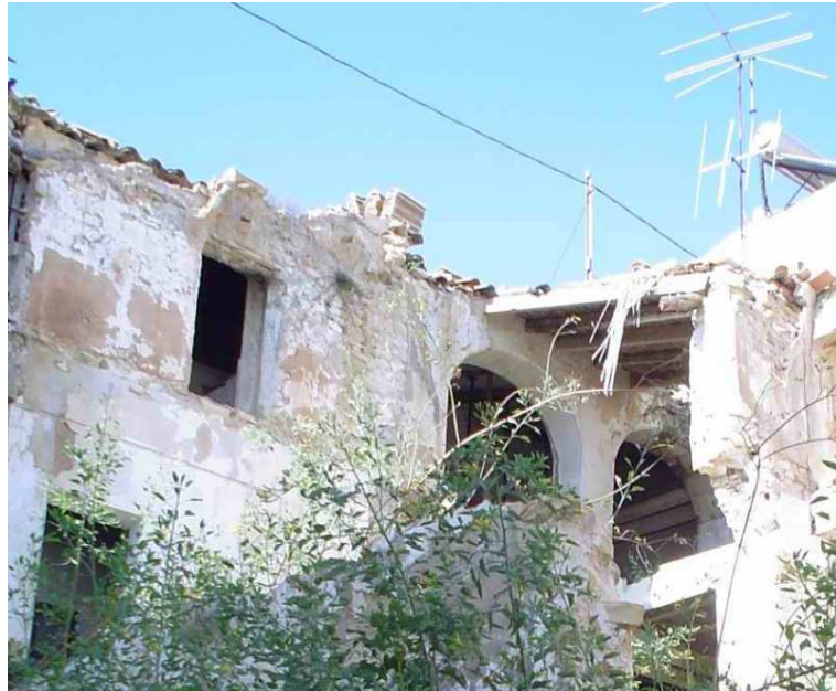
Figura 11. Fachada posterior deteriorada como consecuencia del derribo de la tercera casa. Propiedad del arquitecto municipal.
