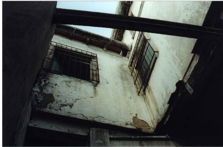
1. Patio interior donde predominan las humedades por falta de luz solar.
