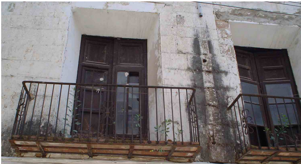
Figura 13. Estado desmejorado de la carpintería. Elaboración propia
