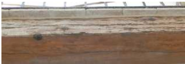
Figura 52. Jácena de madera con termitas perteneciente a los forjados superiores. Elaboración propia
