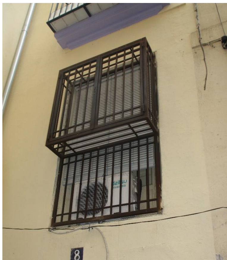
Imagen 67. Elementos de protección 2 (Fuente propia)
