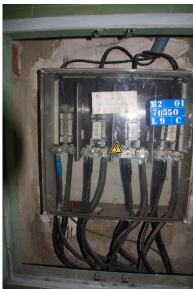
Imagen 56. Contador eléctrico (Fuente propia)
