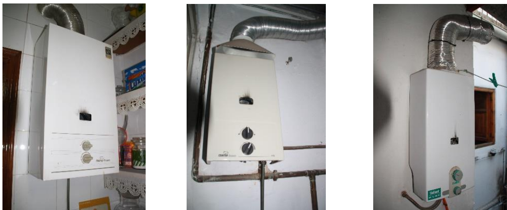
Imagen 54. Calderas de Planta 2, 3 y 4 (Fuente propia)
