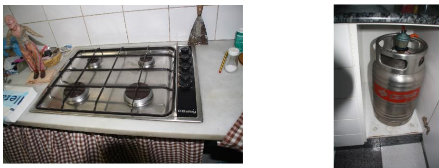
Imagen 55. Suministro de gas para cocina (Fuente propia)
