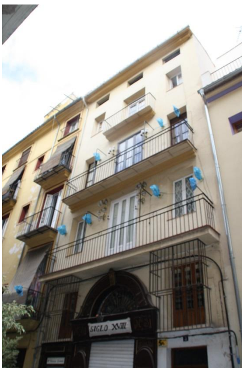
Imagen 68. Elementos de protección 3 (Fuente propia)
