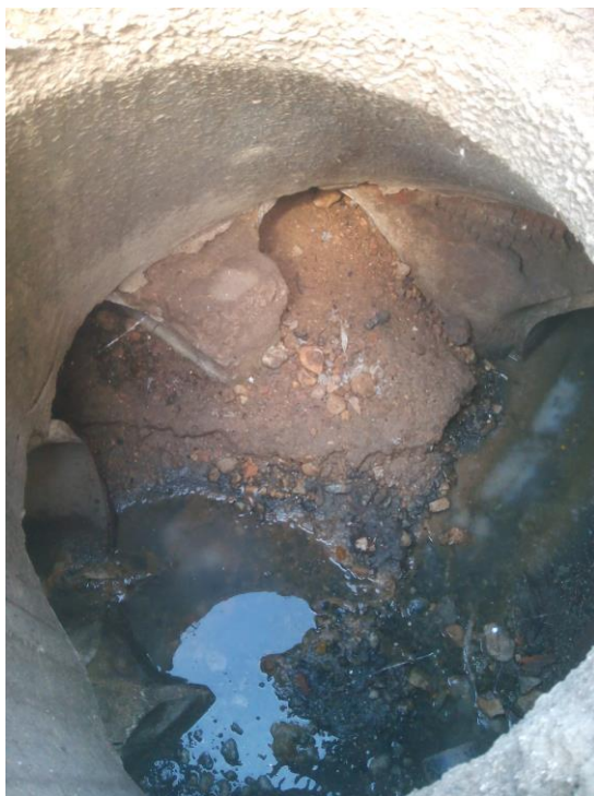
Mal estado de algunos pozos de registro
