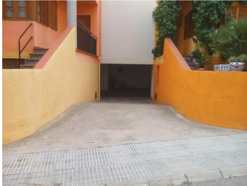
Bajo semienterrado que sufre inundaciones
