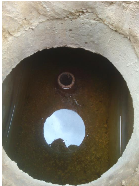
Cámara de descarga fuera de servicio
