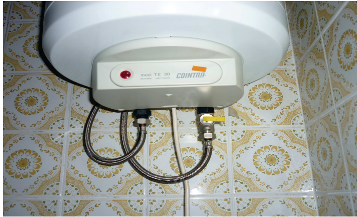
Figura 25: Acumulador de ACS existente.
