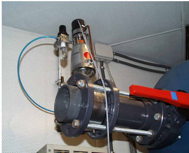
Figura 4.6 Válvulas electroneumáticas de la instalación.
