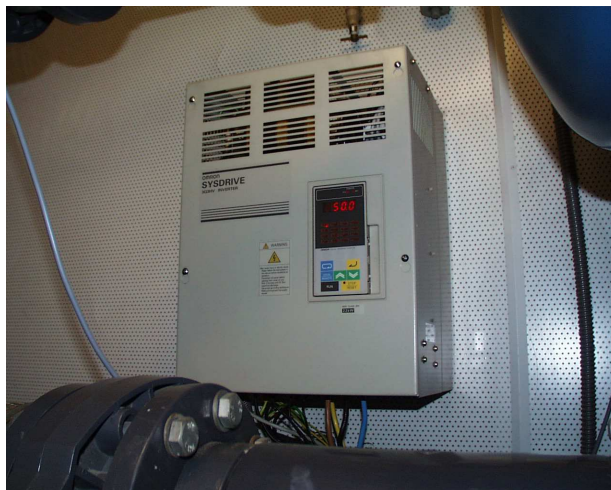
Figura 4.5 Variador de frecuencia de la instalación.
