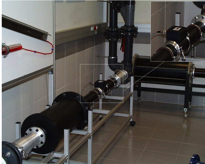
Figura 4.10 Montaje del Sensyflow en línea.
