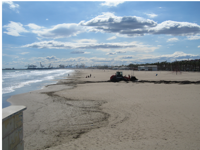
Figura 3: Playa de la Malvarrosa, donde se van a llevar a cabo los trabajos
