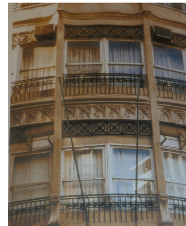
▲ Imagen 20. Mirador antes de realizar intervención de AIC Equip. Se pueden apreciar las antiguas carpinterías.
