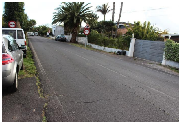
Ilustración 9 - Estacionamiento en el arcén de la calzada.
