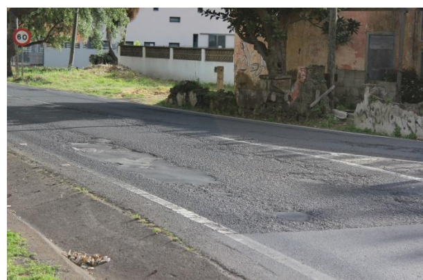
Ilustración 12 - Estado del firme en el Tramo II.
