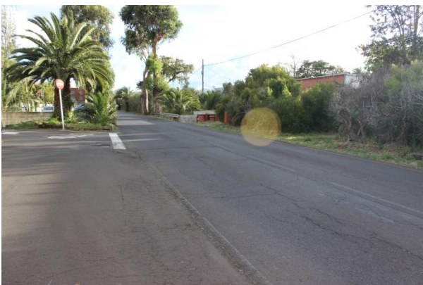
Ilustración 11 - Estado del firme en el Tramo I.
