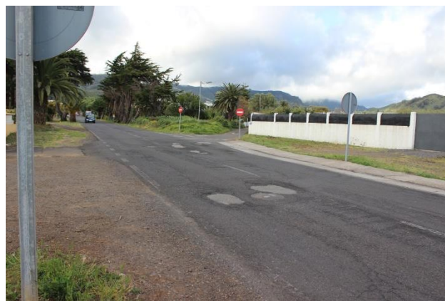
Ilustración 8 - Estado actual de la carretera.
