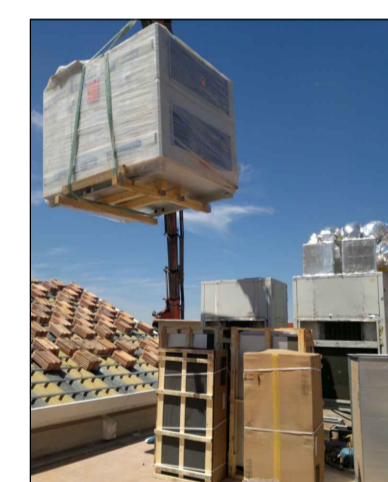
Elevación de las máquinas y recuperador al forjado técnico, especialmente construido con esta finalidad, sobre el ubicación de las máquinas.
