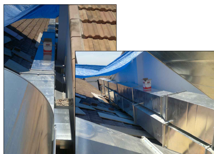
Conductos exteriores para impulsión-retorno aire del salón de baile en zona Este.
