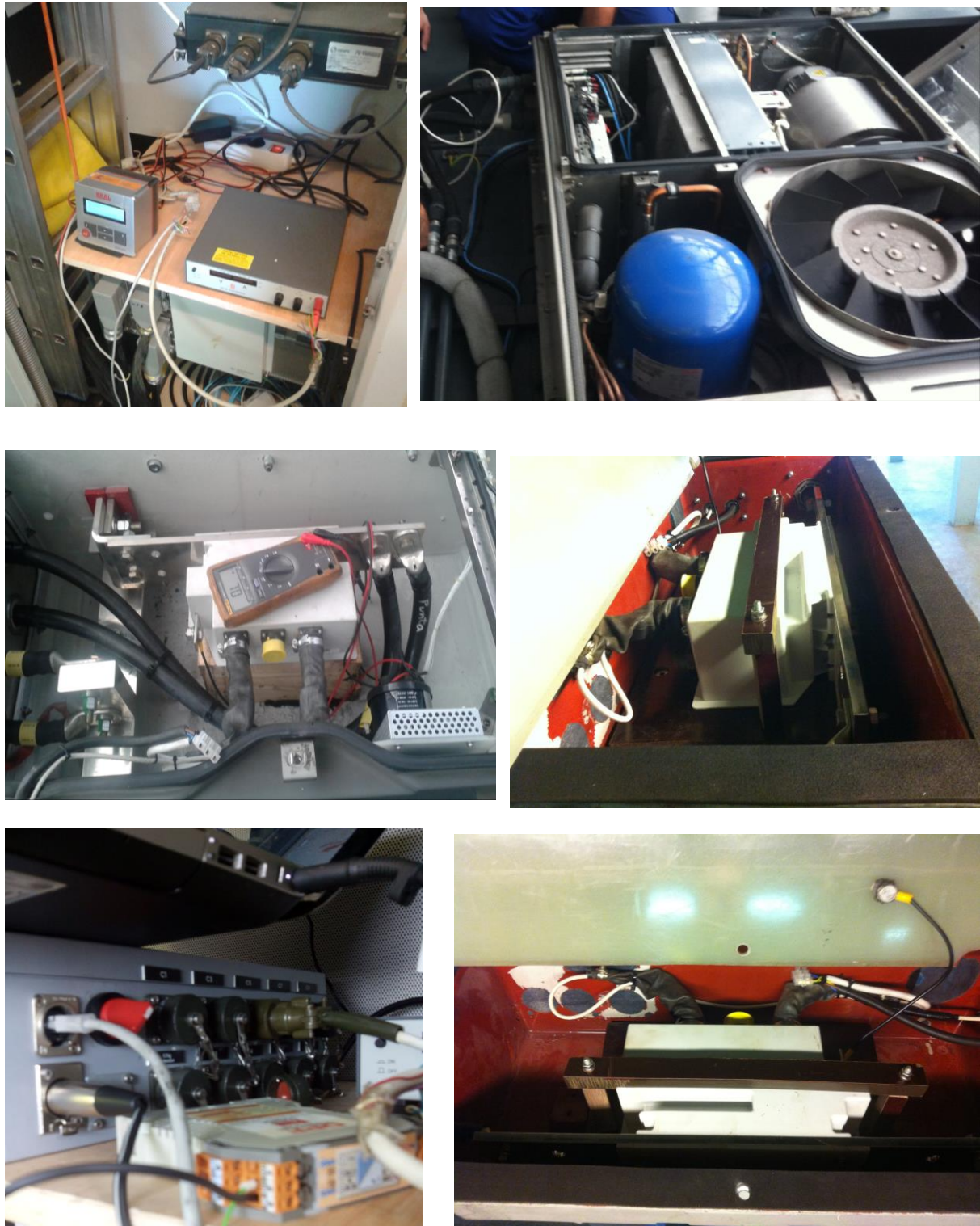
Figura 5.5. Imágenes de los dispositivos instalados. Elaboración propia.
