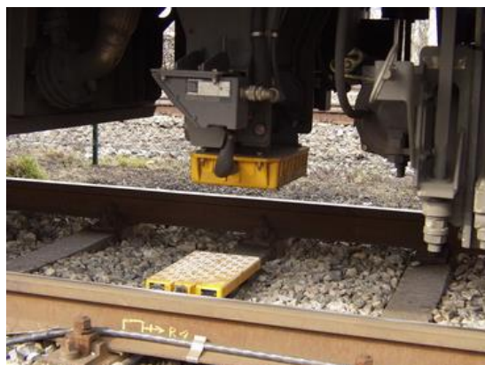
Figura 2.2. Baliza ATP (sobre traviesa) y antena de recepción en vehículo (arriba). Fuente: https://ruedaycarril.wordpress.com/ (accedido el 7 de Jun de 2015).
