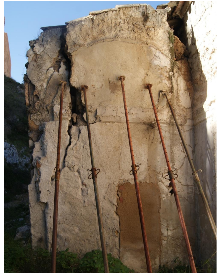
Figura 2.107– Grietas verticales en el muro de cierre de fachada sur. (David Clarí, 2014)
