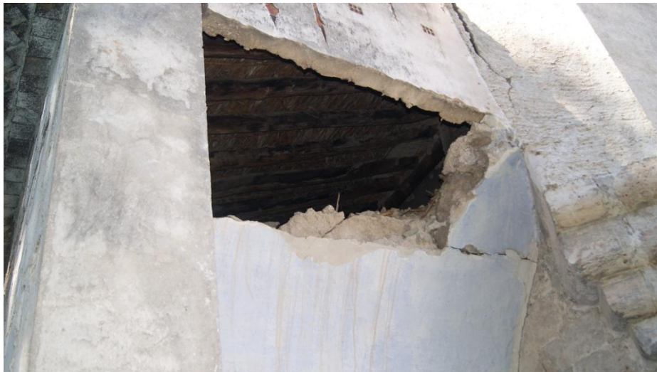
Figura 4.4 – Rotura de bóveda en fachada este. (David Clarí, 2014)
