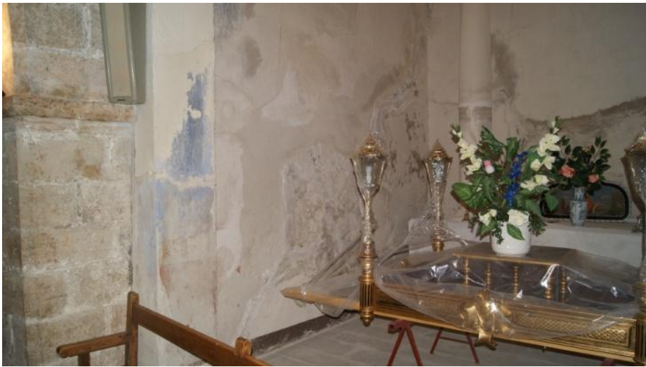
Figura 2.100 – Precipitación de sales en el cerramiento del edificio. (David Clarí, 2014)
