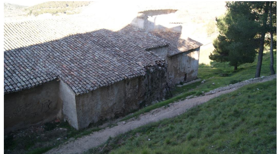
Figura 4.5 – Efectos de la humedad en fachada sur. (David Clarí, 2014)
