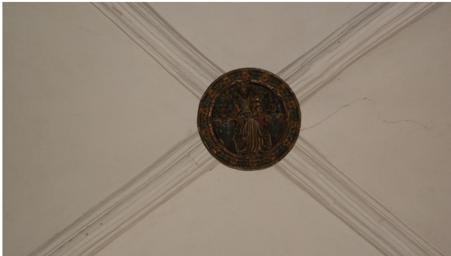
Figura 2.111– Fisuras en revestimiento bóveda de crucería. (David Clarí, 2014)
