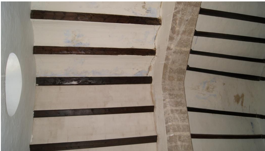
Figura 2.109– Grieta entre entrevigado y el arco apuntado. (David Clarí, 2014)
