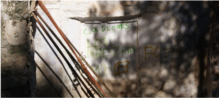
Figura 4.10 – Grafitis en el exterior del edificio. (David Clarí, 2014)
