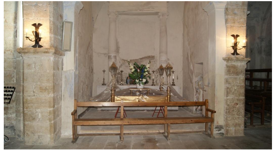
Figura 2.102 – Precipitación de sales las capillas del edificio. (David Clarí, 2014)
