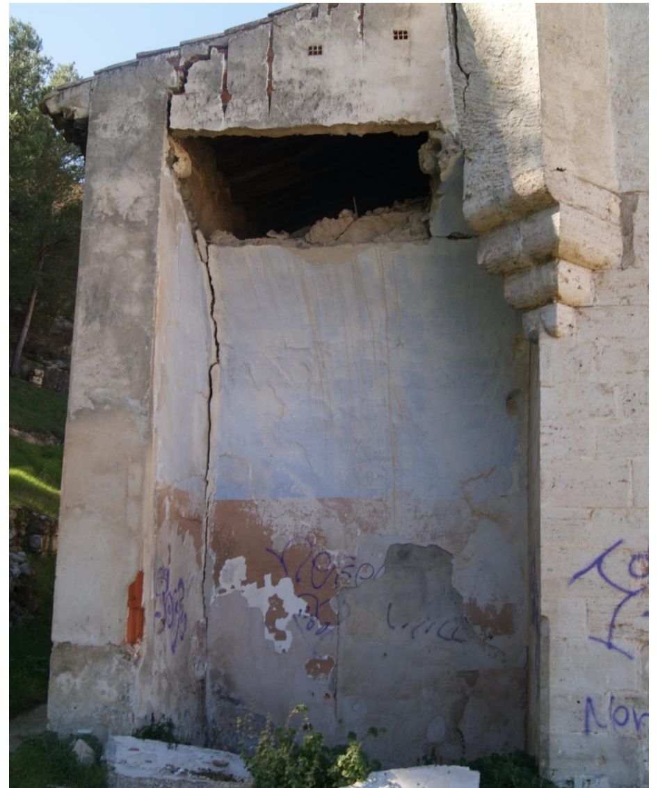
Figura 2.110– Grieta entre la fábrica y la bóveda de cañón apuntado. (David Clarí, 2014)
