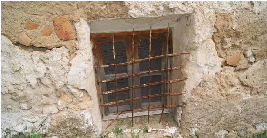
Figura 4.11 – Elementos oxidados en fachada. (David Clarí, 2014)
