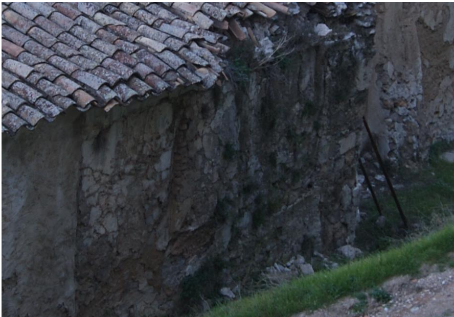
Figura 4.22 – Pérdida de masa en muros de mampostería. (David Clarí, 2014)
