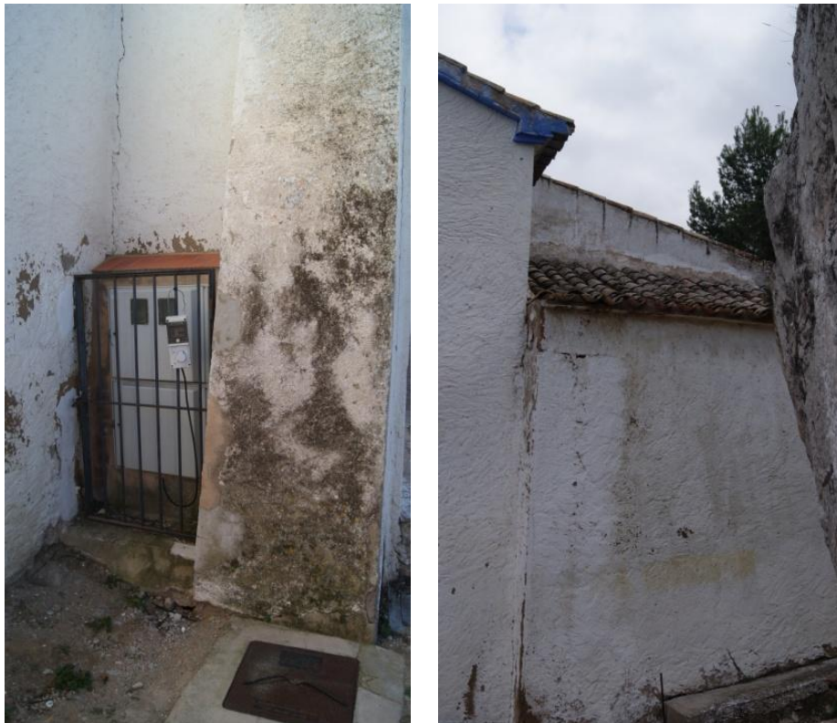
Figura 2.90-2.91 – Ensuciamiento orgánico en distintos puntos de las fachadas del edificio. (David Clarí, 2014)
