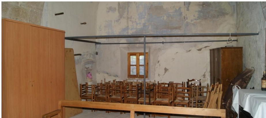
Figura 4.24 – Pérdida de masa en muros de mampostería. (David Clarí, 2014)
