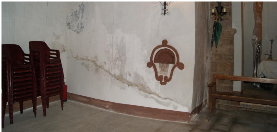
Figura 4.16 – Humedad por capilaridad en el lado del evangelio. (David Clarí, 2014)
