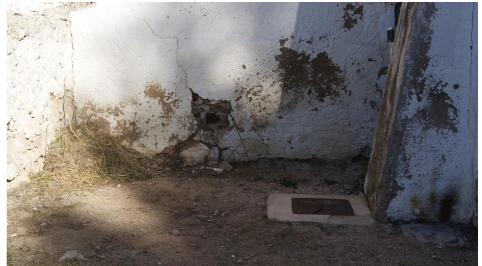
Figura 4.9 – Pérdida de revestimientos en el exterior del edificio. (David Clarí, 2014)
