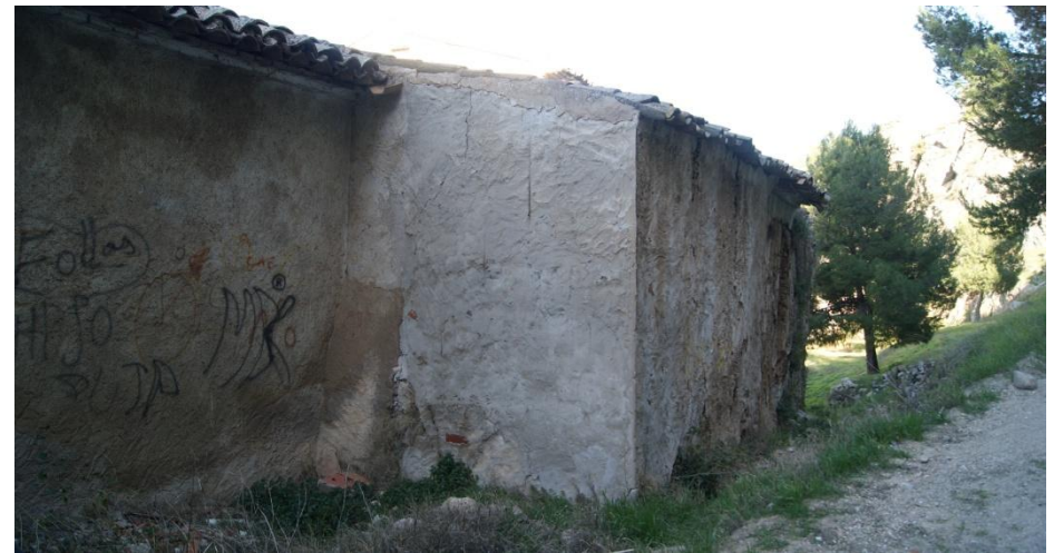
Figura 2.121– Aplicación de mortero de cemento en parte de la superficie del muro. (David Clarí, 2014)
