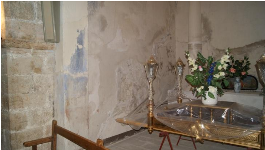
Figura 4.27 – Precipitación de sales en el cerramiento del edificio. (David Clarí, 2014)
