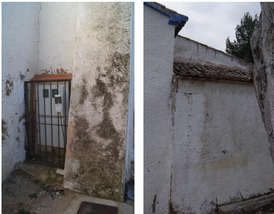
Figura 4.12-4.13 – Ensuciamiento orgánico en las fach. del edificio. (David Clarí, 2014)
