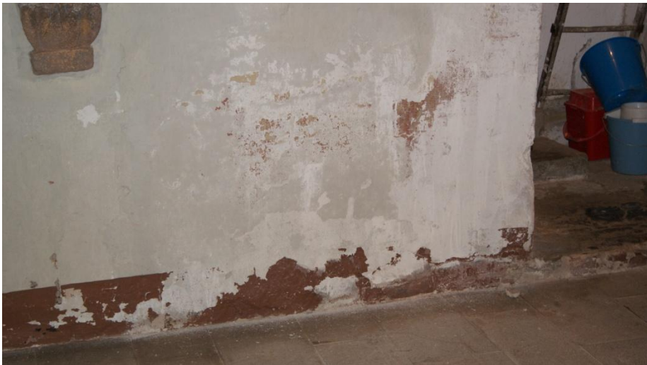
Figura 2.101 – Precipitación de sales en el cerramiento del edificio. (David Clarí, 2014)
