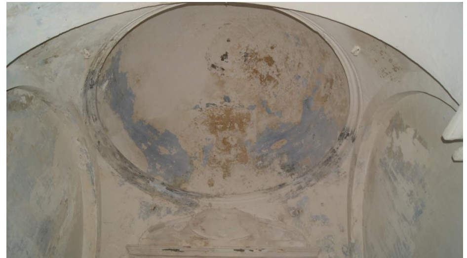
Figura 2.98 – Humedad por filtración en la cúpula de una capilla. (David Clarí, 2014)
