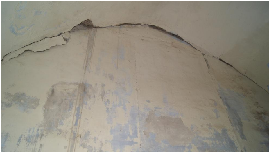
Figura 2.108– Grieta entre la fábrica y la bóveda de cañón apuntado. (David Clarí, 2014)
