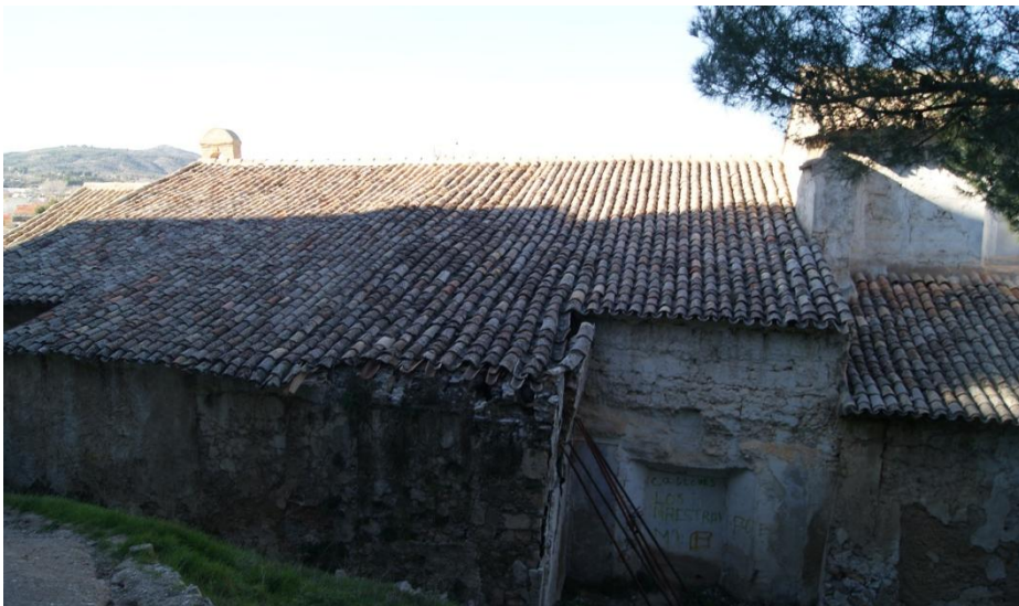
Figura 2.106– Efectos de la erosión en los muros del edificio. (David Clarí, 2014)
