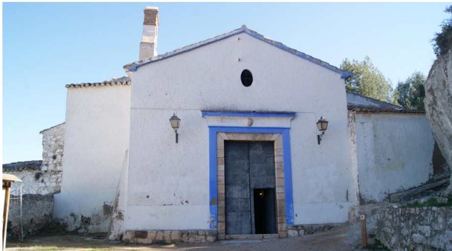
Figura 2.26 – Estado actual de la fachada este del edificio. (David Clarí, 2014)
