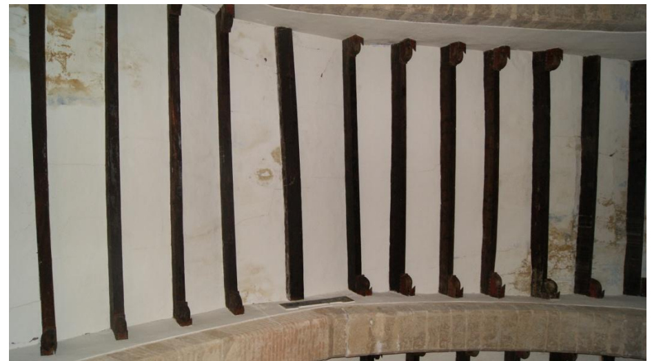
Figura 2.99 – Humedad por filtración en el cerramiento de la nave. (David Clarí, 2014)
