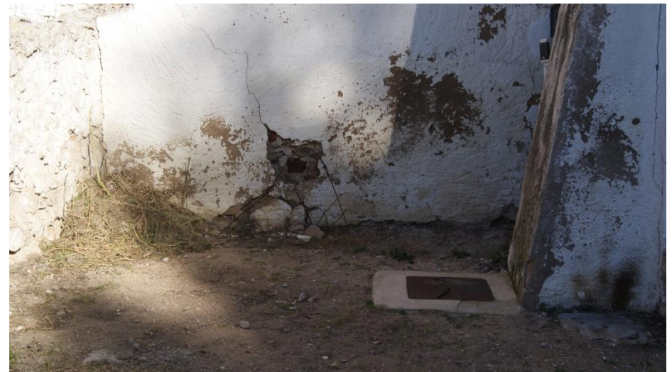
Figura 2.115– Pérdida de revestimientos en fachada oeste. (David Clarí, 2014)
