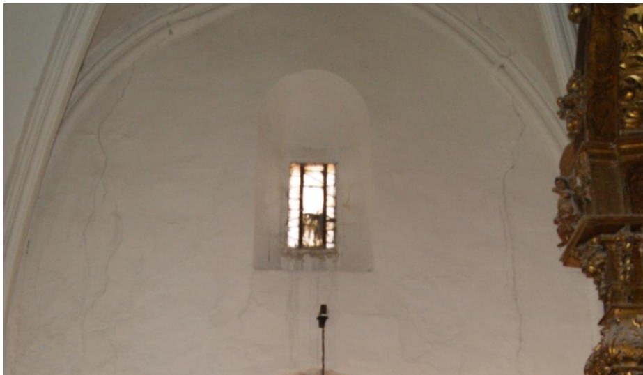
Figura 2.112– Fisuras en revestimiento presbiterio. (David Clarí, 2014)
