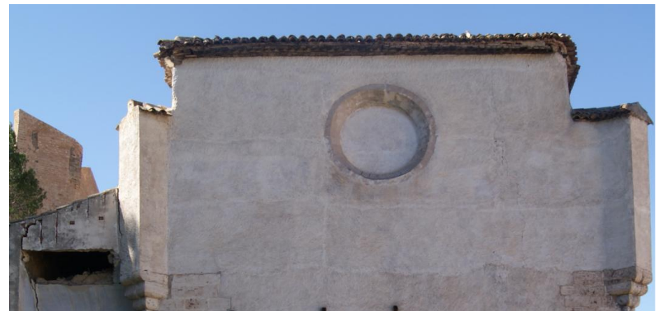
Figura 2.89 – Suciedad inorgánica en la fachada este del edificio. (David Clarí, 2014)
