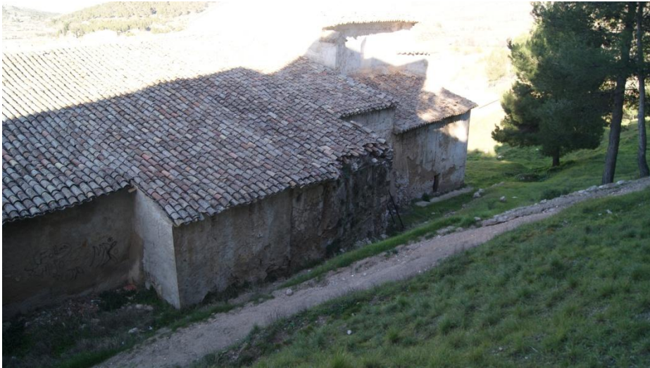
Figura 2.105– Efectos de la erosión en los muros del edificio. (David Clarí, 2014)
