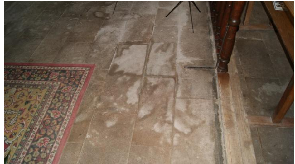
Figura 2.103 – Precipitación de sales en el pavimento del edificio. (David Clarí, 2014)
