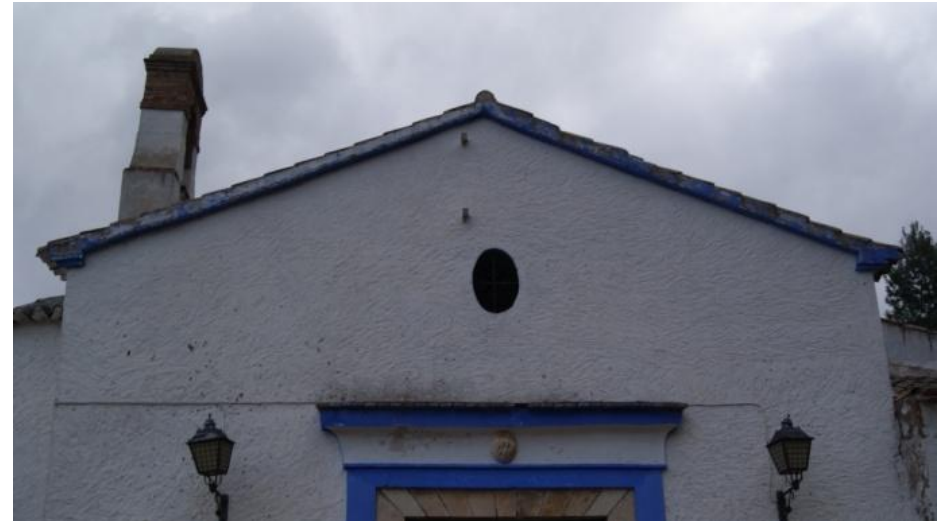
Figura 2.88 – Suciedad inorgánica en la fachada principal del edificio. (David Clarí, 2014)
