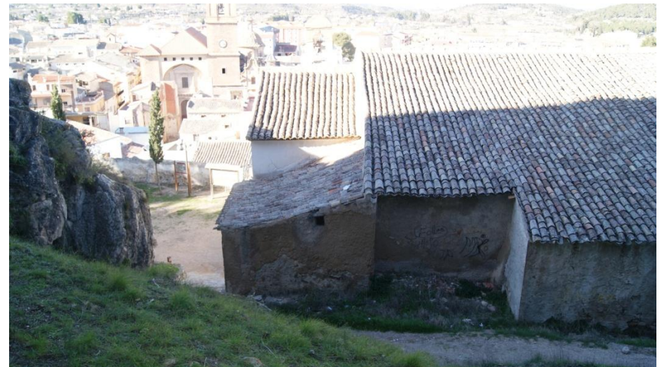
Figura 2.114– Pérdida de revestimientos en fachada sur. (David Clarí, 2014)
