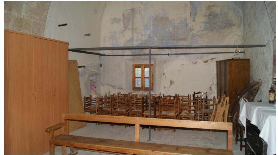
Figura 2.96 – Humedad por capilaridad en el lado de la epístola. (David Clarí, 2014)
