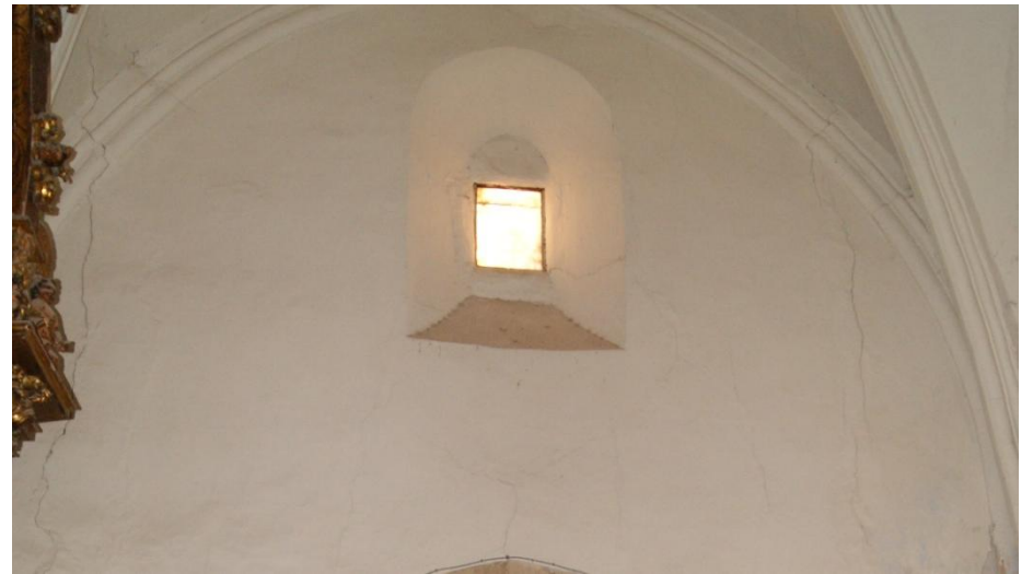
Figura 2.113– Fisuras en revestimiento presbiterio. (David Clarí, 2014)
