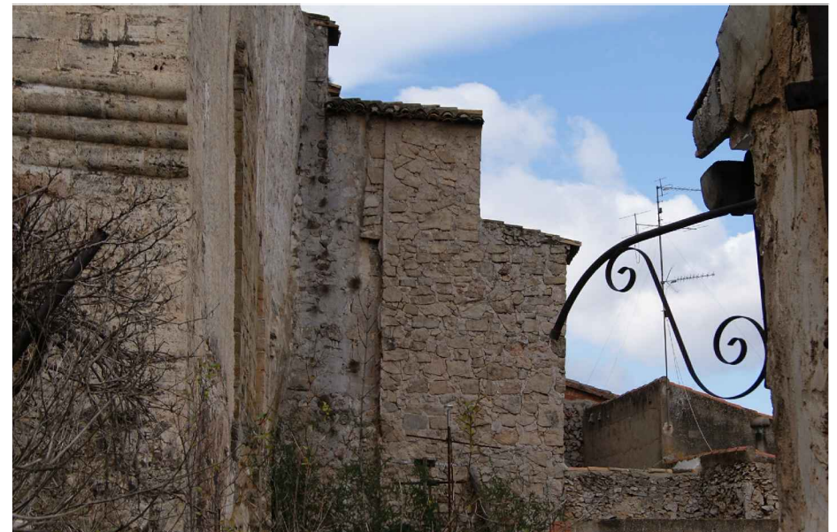
Figura 2.44 - Mampostería careada en uno de los contrafuertes de la fachada norte. (David Clarí, 2014)
