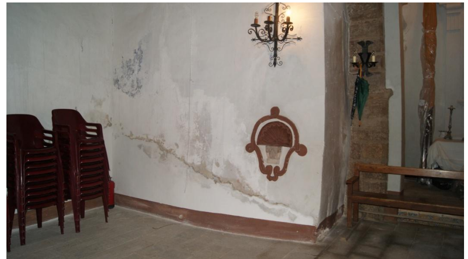
Figura 2.97 – Humedad por capilaridad en el lado del evangelio. (David Clarí, 2014)
