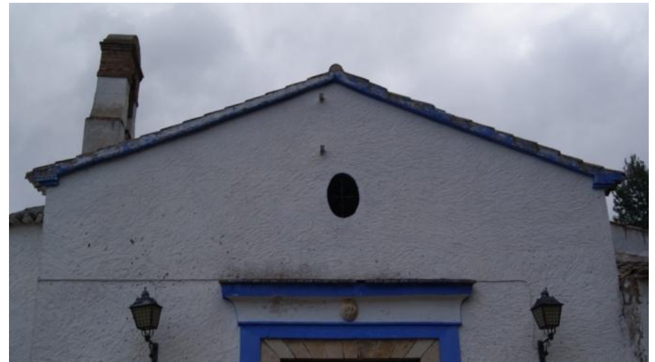
Figura 4.15 – Suciedad inorgánica en la fachada principal del edificio. (David Clari, 2014)
