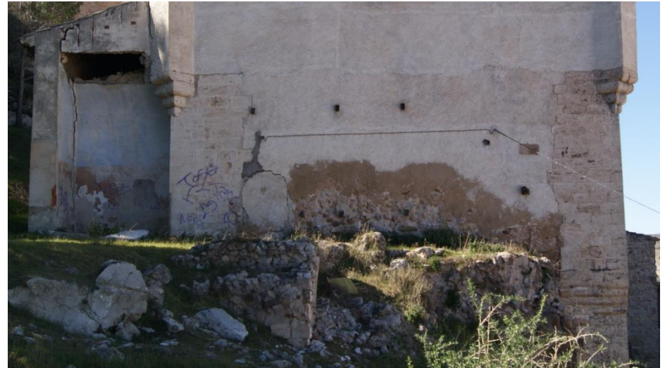
Figura 2.106– Efectos de la erosión en muros y sillares del edificio. (David Clarí, 2014)
