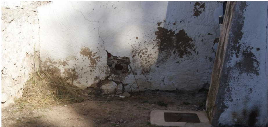
Figura 4.26 – Pérdida de revestimientos en muros de mampostería. (David Clarí, 2014)
