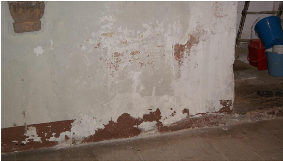
Figura 4.6 – Efectos de la humedad y las eflorescencias en el interior del edificio. (David Clarí, 2014)
