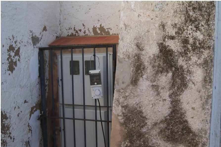
Figura 4.8 – Suciedad orgánica en el exterior del edificio. (David Clarí, 2014)
