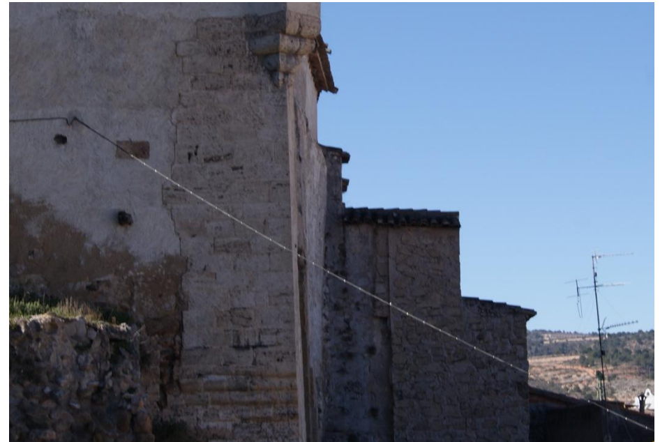
Figura 2.104– Efectos de la erosión en los sillares del edificio. (David Clarí, 2014)
