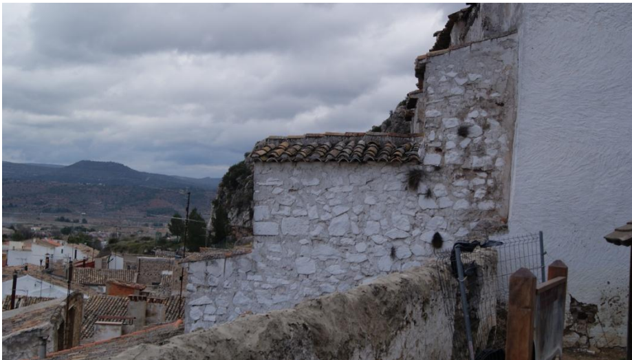
Figura 2.93 – Vegetales superiores en el contrafuerte del edificio. (David Clarí, 2014)
