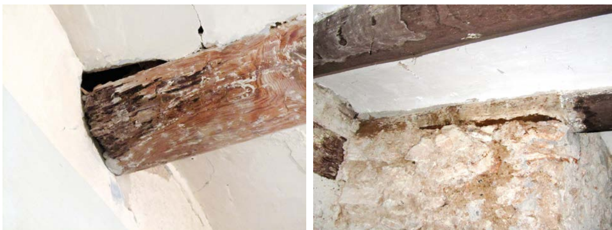
Figura 7.49. Degradación en el apoyo este de la viga 0C_03. Apoyo de la viga 0I_05 en el muro del pozo. (Grupo de investigación IRP-UPV – CNR-IVALSA)
