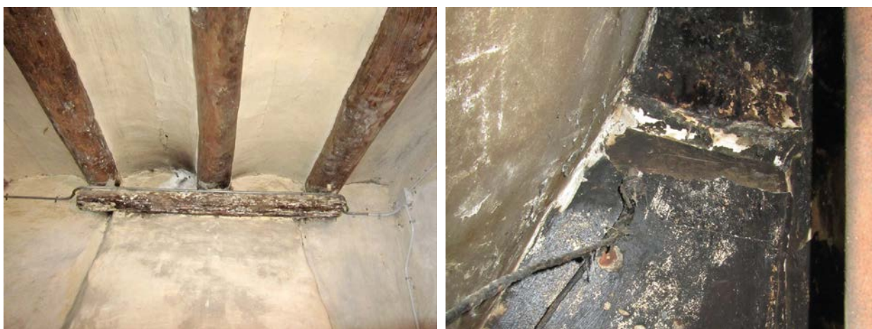
Figura 7.46. Encuentro entre las vigas y la campana de la chimenea, disposición de las vigas en la habitación. El dintel está colgado de las vigas laterales mediante dos clavos. Extremo norte de la viga 0J_02 en una vista desde el interior de la chimenea. (Grupo de investigación IRP-UPV – CNR-IVALSA)
