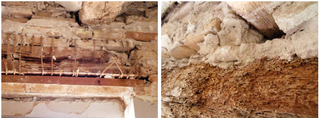
Figura 7.9. Detalles de los dinteles I_D-01 y I_D-02. Elementos degradados reutilizados.
