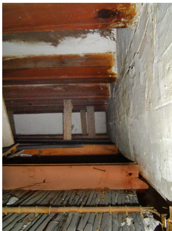
Figura 4.37. Ejemplo del falso techo colgado realizado con entramado de madera, paneles de cañas y acabado de yeso inferior, Facultad de Teología, Valencia, construido alrededor de 1829-1853.
