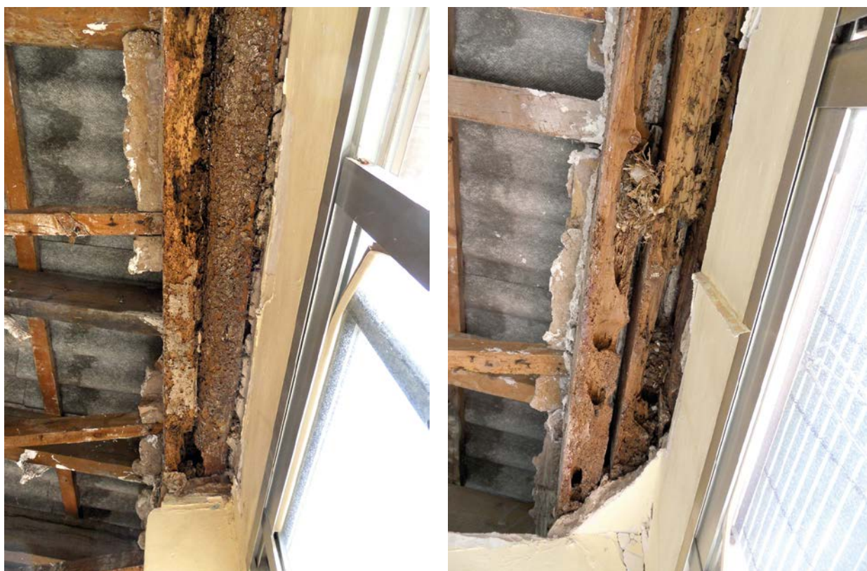
Figura 7.18. Profundo estado de degradación de los dinteles IV_D-02 y IV_D-03.
