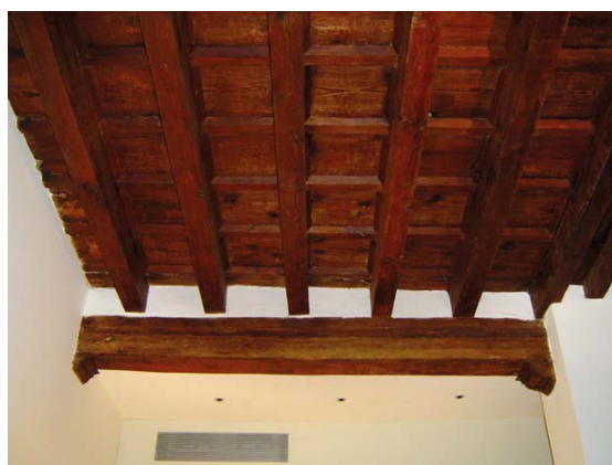
Figura 4.19. Forjado de la primera planta de la casa en Calle Ángel Custodio 4.
