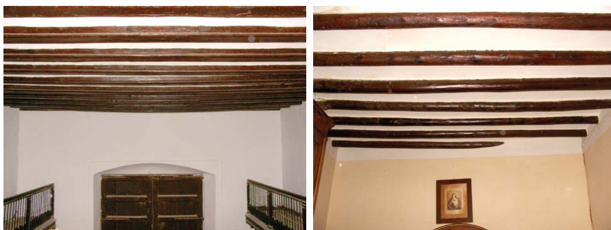
Figura 7.54. Deformación de las vigas en los forjados 1F y 1P. (Grupo de investigación IRP-UPV – CNR-IVALSA)
