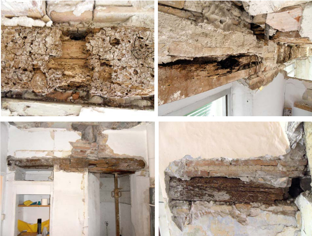
Figura 7.10. Profundo estado de degradación de los dinteles I_D-03, I_D-04, I_D-05 y I_D-10
