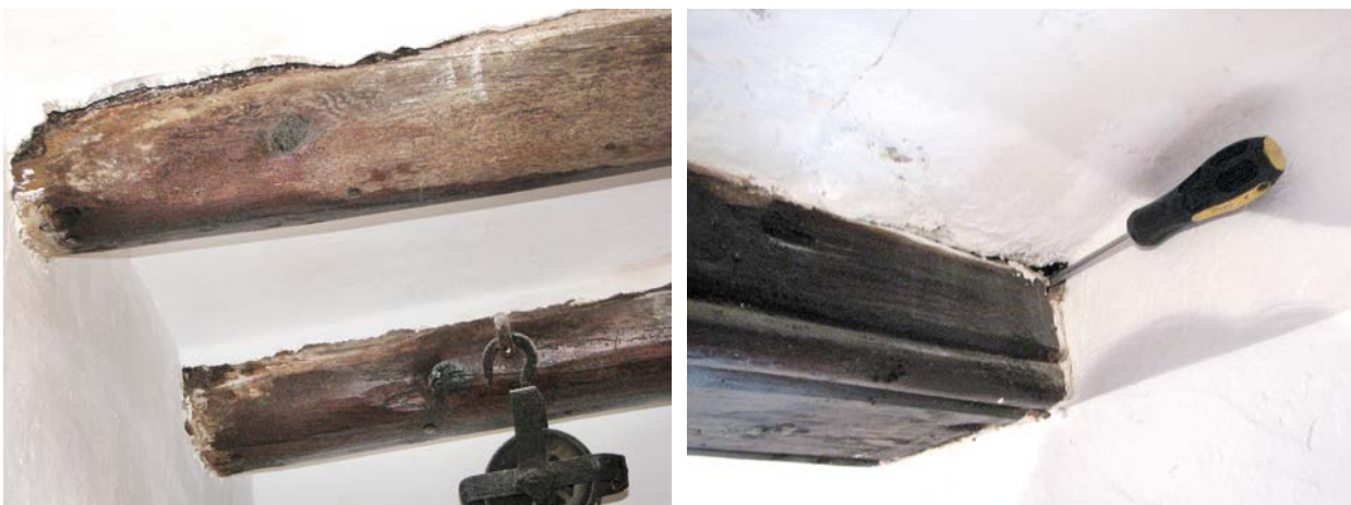
Figura 7.53. Degradación en los apoyos. Daños en el trasdós de las vigas 1E_08-09. Destornillador penetrando en el apoyo de la viga 1A_05. (Grupo de investigación IRP-UPV – CNR-IVALSA)
