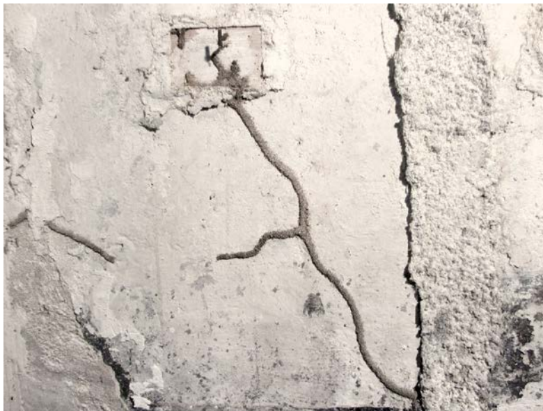
Figura 7.52 Galerías construidas por las termitas bajo la ventana en la habitación 1N. (Grupo de investigación IRP-UPV – CNR-IVALSA)
