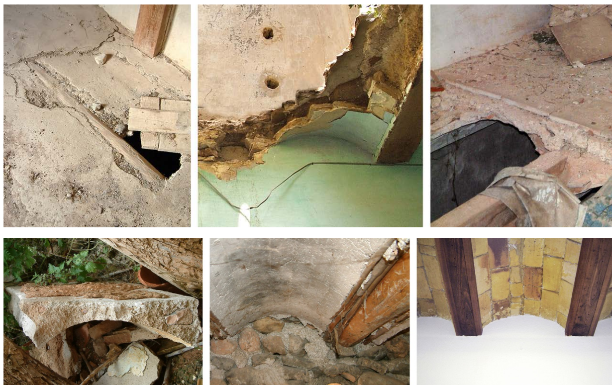
Figura 4.44. Sección de las bovedillas, ejemplos de estructuras colapsadas donde es posible apreciar la condición de coplanaridad entre el trasdós de las vigas y de la bovedilla, lo que lleva a un espesor muy reducido del forjado. Edificios cerca de Cabanes, provincia de Castellón de la Plana, Albalat de la Ribera y Gandía, ambos en provincia de Valencia. Ejemplos de materiales constructivos de la bovedillas: una porción de bovedilla de conglomerado de yeso con piezas de ladrillo visibles en la sección, ruinas noreste de Requena, Valencia; bovedillas de conglomerado de yeso con un grupo de cañas en el arranque, casa cerca de Cofrentes, Valencia; forjado de revoltones con bovedillas de rasilla y viguetas compuestas, casa de la familia Vallier, Valencia, edificada a partir de 1883.
