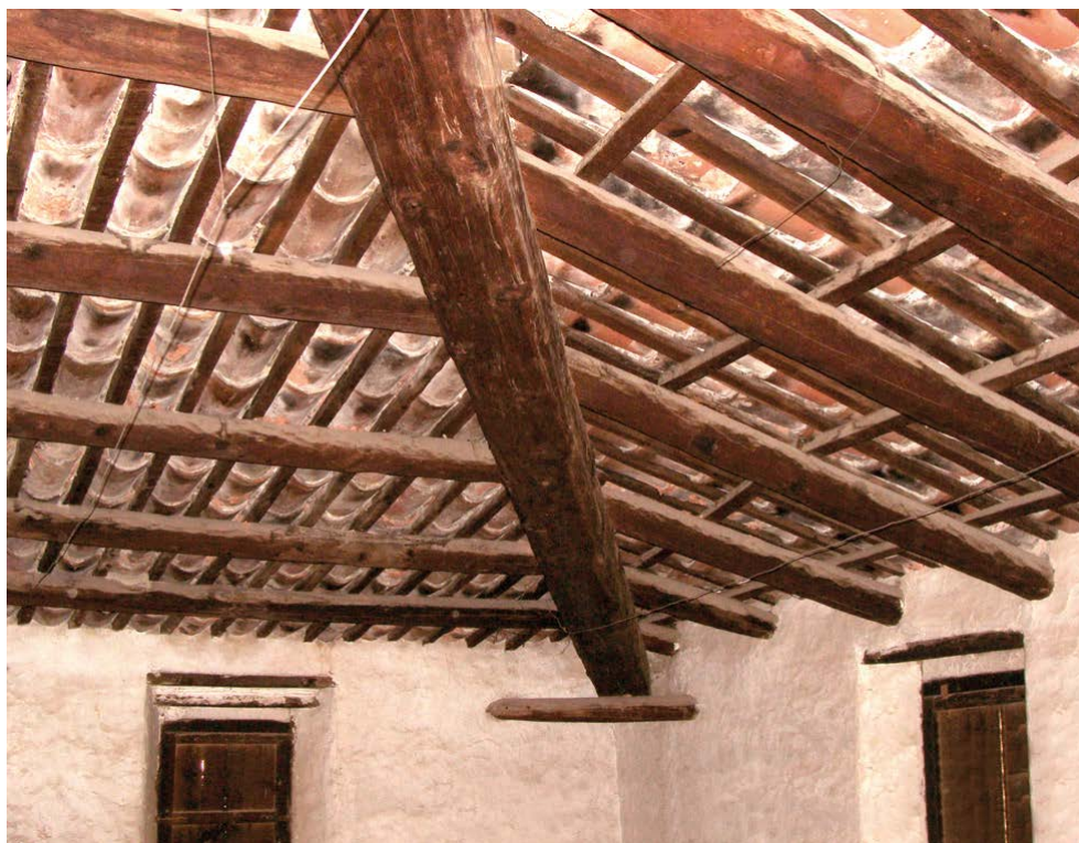
Figura 7.30. Estructura de la cubierta del Palacio del Marqués de Benicarló. (Grupo de investigación IRP-UPV – CNR-IVALSA)
