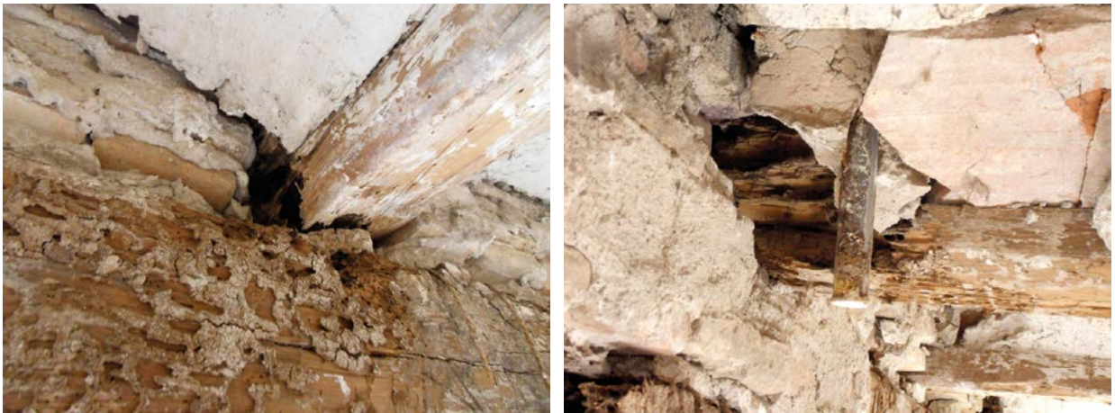
Figura 7.11. Profundo estado de degradación de los apoyos este de las vigas I_V-08 e I_V-10
