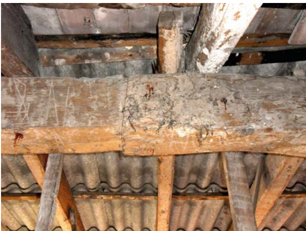
Figura 7.16. Reducción de sección de la viga principal.
