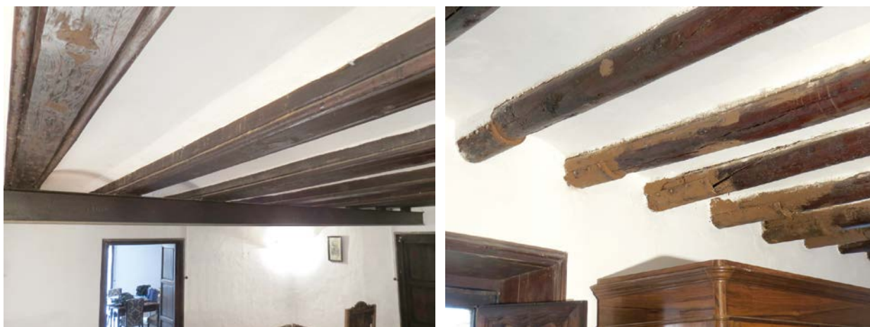
Figura 7.51. Refuerzos metálicos. Perfil de refuerzo en la habitación 1H. Planchas metálicas curvadas en la habitación 1P. (Grupo de investigación IRP-UPV – CNR-IVALSA)
