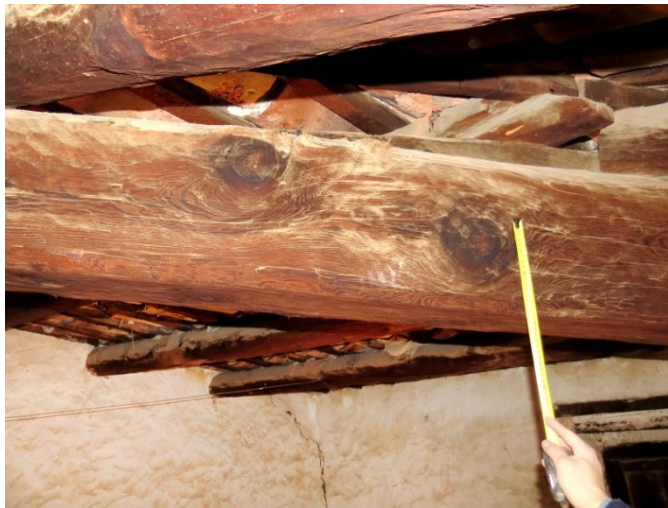
Figura 7.3. Nudos en 3A_08. A pesar de su tamaño, la viga pertenece a la clase III y no ha sido descartada para su uso estructural.
