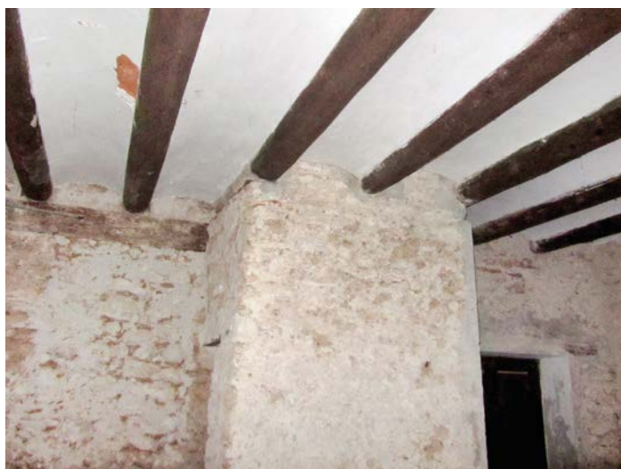
Figura 7.47. Pozo en la habitación 0I. La estructura del pozo sube hasta la primera planta donde se abre en la cocina del siglo XVIII. (Grupo de investigación IRP-UPV – CNR-IVALSA)
