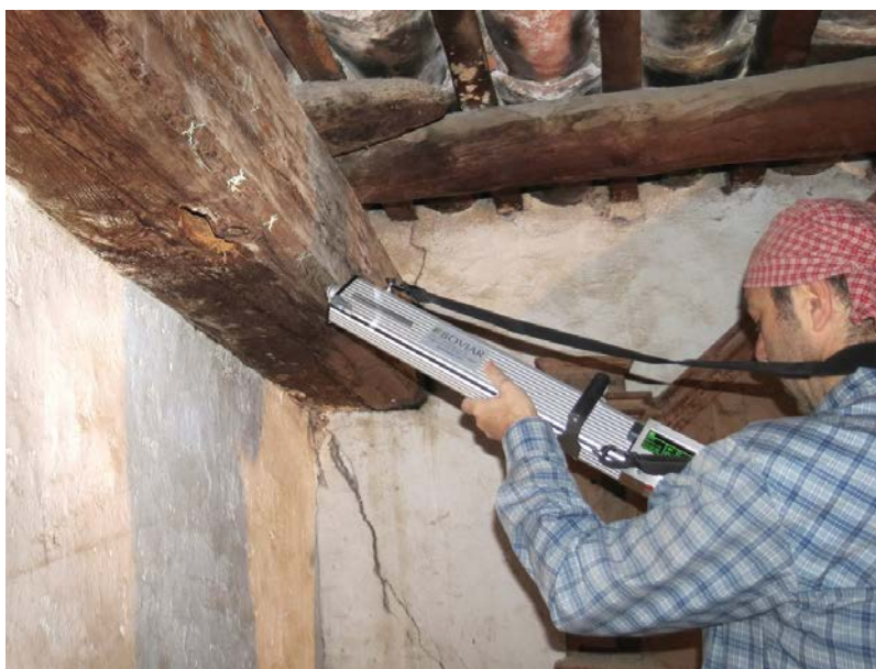
Figura 7.27. Un investigador utilizando el taladro resistográfico IML-PD400 en una viga de la cubierta. (Grupo de investigación IRP-UPV – CNR-IVALSA)
