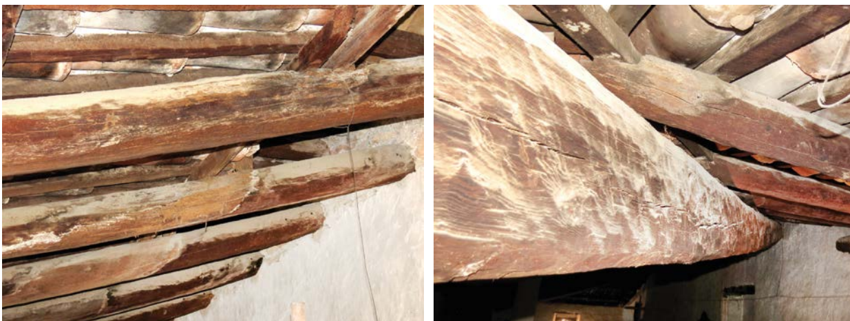
Figura 7.58. Degradación superficial localizada. Vigas 3A_17-19. (Grupo de investigación IRP-UPV – CNR-IVALSA)
