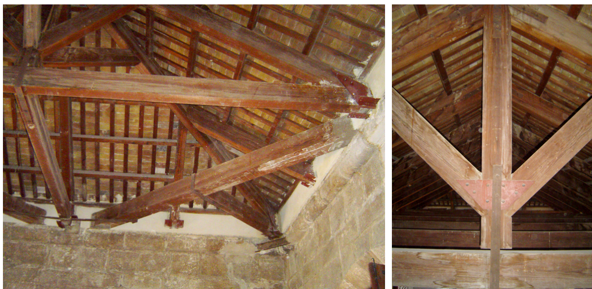
Figura 5.4. Cercha en la cubierta del Consulado del Mar al lado de la Lonja de Mercaderes.
