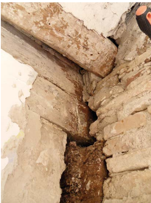
Figura 7.6. Esquina noreste y durmiente, I_V-13.
