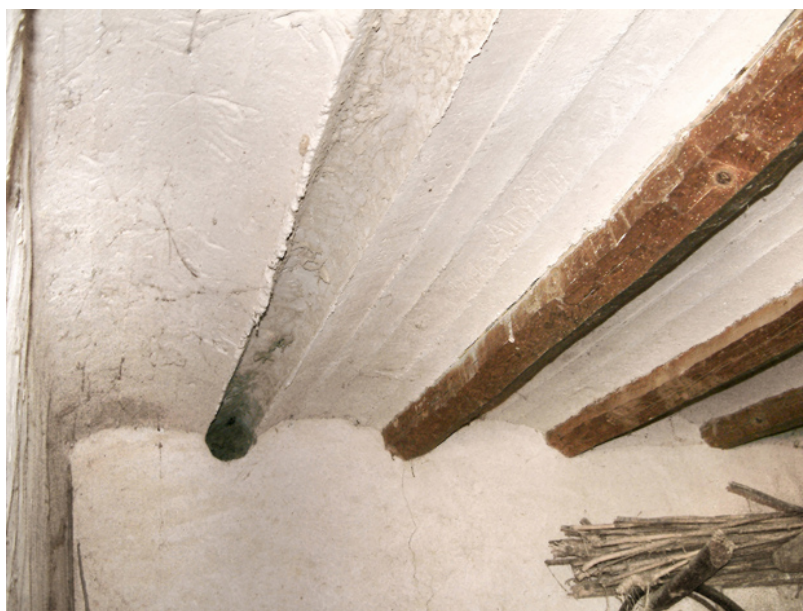
Figura 4.50. Forjado de revoltones con una viga faltante. A pesar de este fallo estructural, la capa de yeso de las bovedillas se sostiene sin problemas. Casa cerca de Cabanes, Castellón de la Plana.
