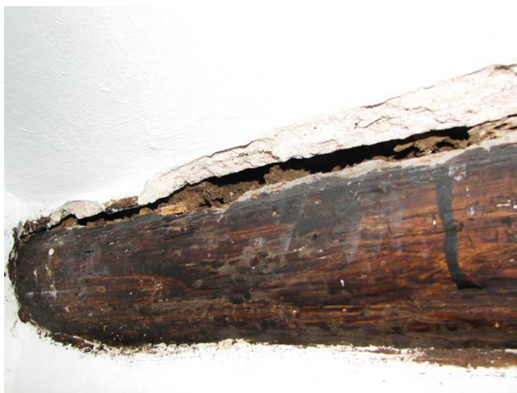
Figura 4.49. Degradación de la superficie entre las vigas de madera y la bovedilla. Trazas de termitas y pudrición parda, palacio del marqués de Benicarló, Benicarló, Castellón de la Plana.
