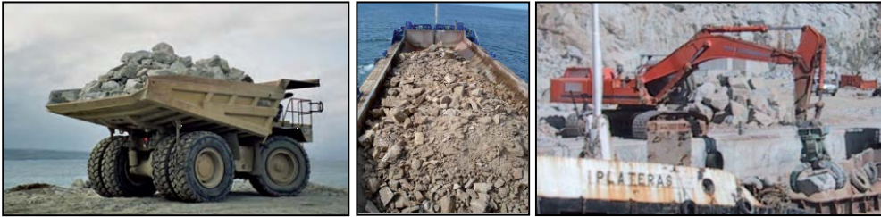
Figura 2.44. Dumper transportando escollera (izq.). Gánguil cargado (centro). Retroexcavadora (dcha.). (Fuente: Guía de Buenas Prácticas para la Ejecución de Obras Marítimas, 2008)
