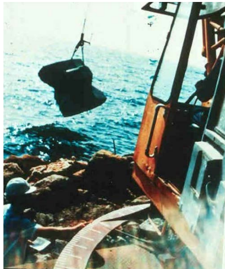
Figura 2.39. Grúa con transportador de ángulos durante la construcción del dique de la dársena de El Saladillo (Puerto de Algeciras), antes de la aparición del GPS. (Fuente: empresa FCC Construcción)
