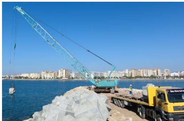
Figura 2.43. Colocación de elementos de protección en el dique de San Andrés (Puerto de Málaga). (Fuente: propia)
