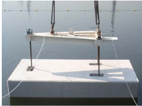
Figura 2.47. Colocación de bloque mediante llaves con forma de T invertida. (Fuente: empresa SATO)
