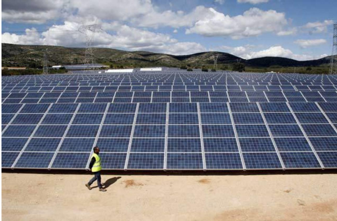
Ilustración 5 Planta solar Benixama de 20Mw.
