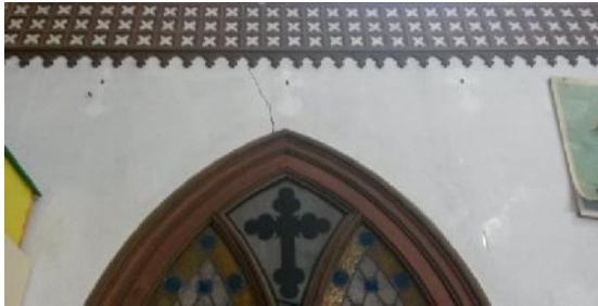
Fig. 64 Grieta interior muro de carga. Fuente: Propia.
