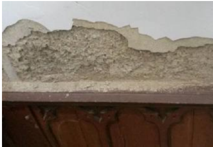
Fig. 68 Arenización. Fuente: Propia.
