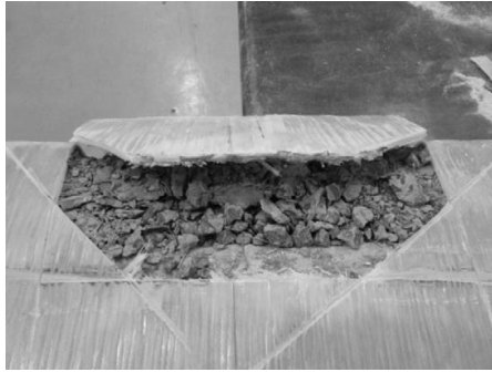
Fig. 2.22 Aplastamiento del hormigón por esfuerzos normales (Chakraborty et al. , 2011).
