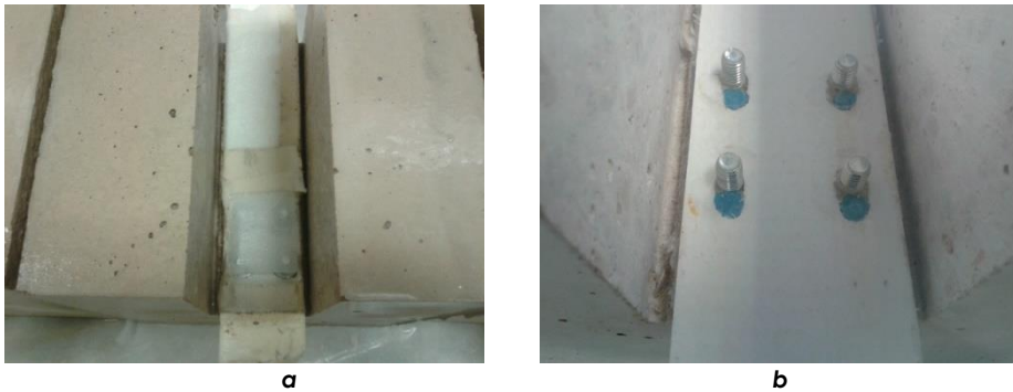
Fig. 5.19 Envoltura de espuma de polietileno (a) y retirada del polietileno, limpieza y tornillería lista para colocar doble arandela y tuerca en la cara opuesta (b).
