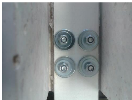
Fig. 5.20 Tornillería lista para el par de apriete posterior en la cara opuesta.
