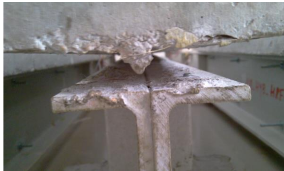
Fig. A1.21 Rotura de los conectores en la viga híbrida HYB_HRF_60.
