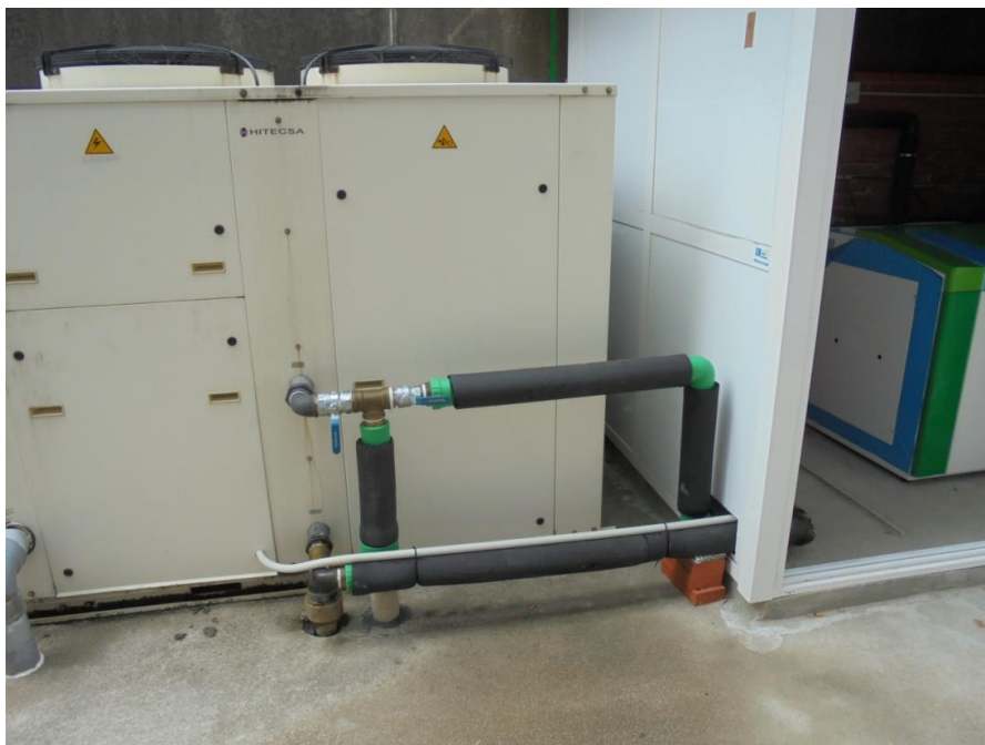
Ilustración 3.16. Bomba de calor aerotérmica y llaves de paso que activan aerotermia y geotermia.
