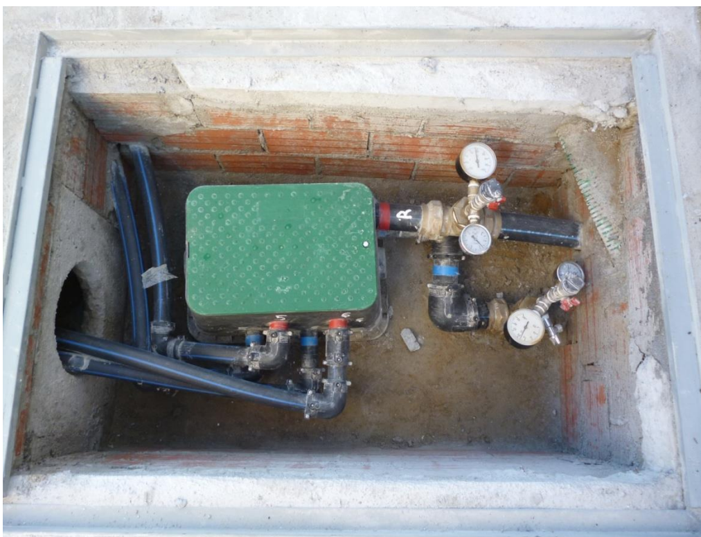
Ilustración 3.12. Circuito de colectores de pozos 4 y 5.
