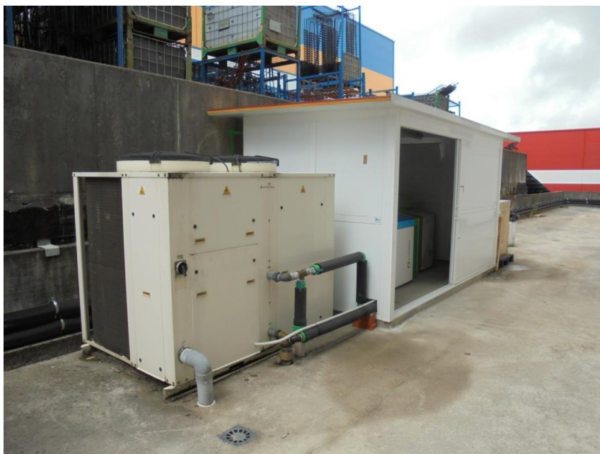
Ilustración 3.15. Bomba de calor aerotérmica.
