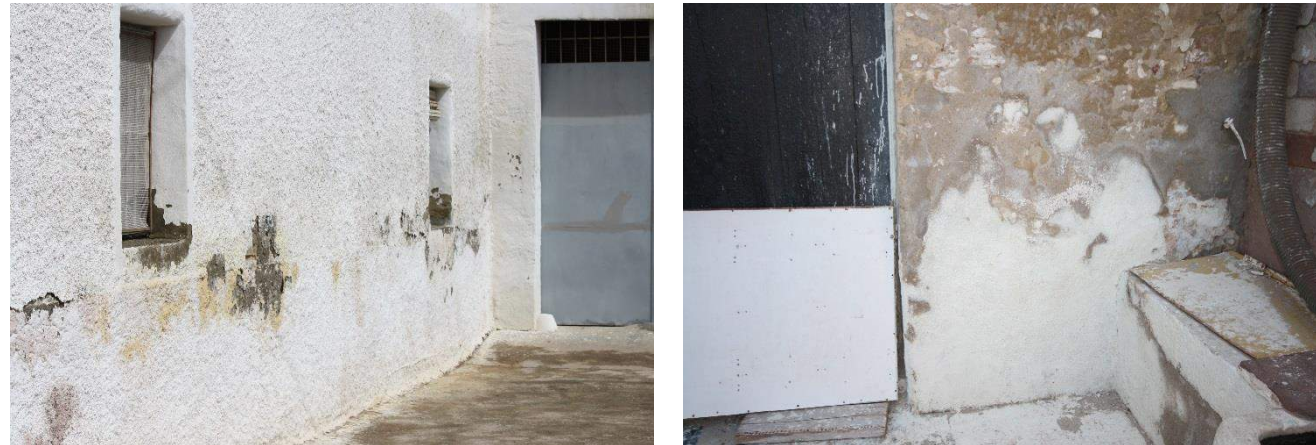
Ilustración 95 Humedades por capilaridad. Autor Propio. 2015.
