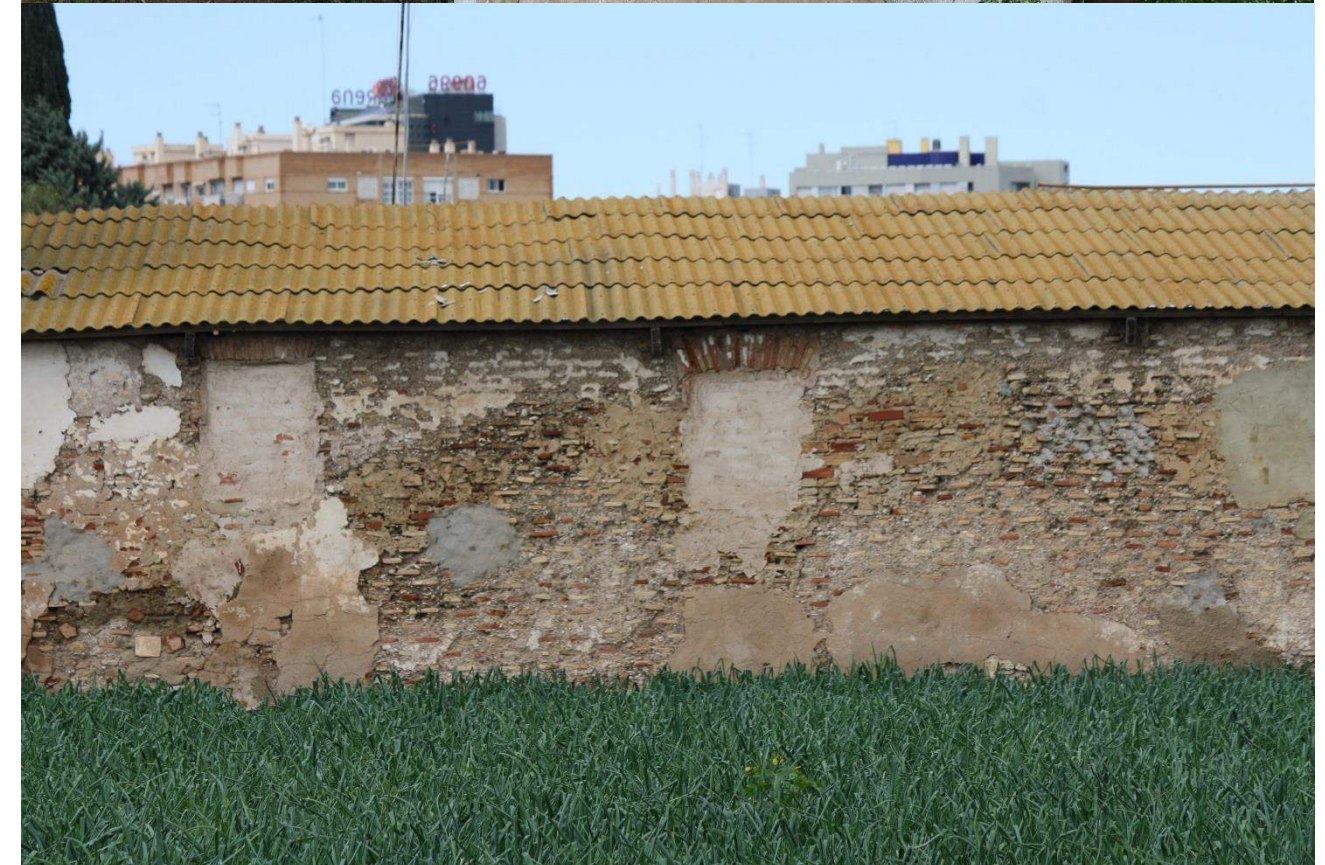
Ilustración 97 Desconchamientos en Fachada de ladrillo macizo y Tapia Valenciana. Autor Propio. 2015.
