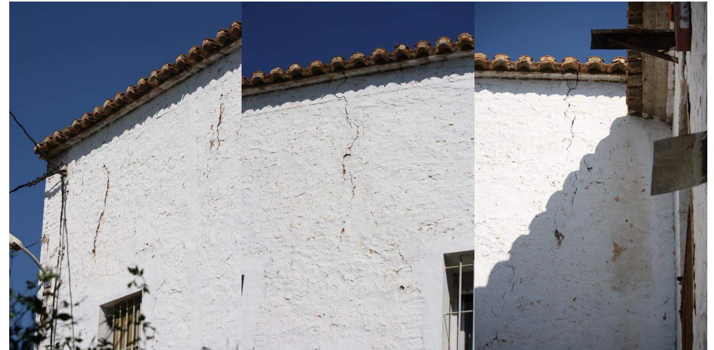
Ilustración 93 Grietas verticales sobre el cerramiento de fachada. Autor Propio. 2015.
