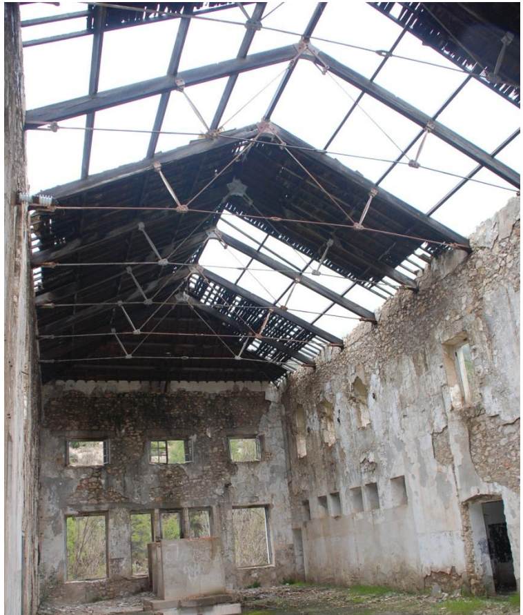
Fig. 7 Estado actual de la cubierta de la linterna del edificio de transformadores.
