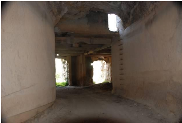
Fig. 15 Acceso al depósito de extremidad desde el túnel excavado. Estado actual (Junio, 2011). Fuente: del autor.
