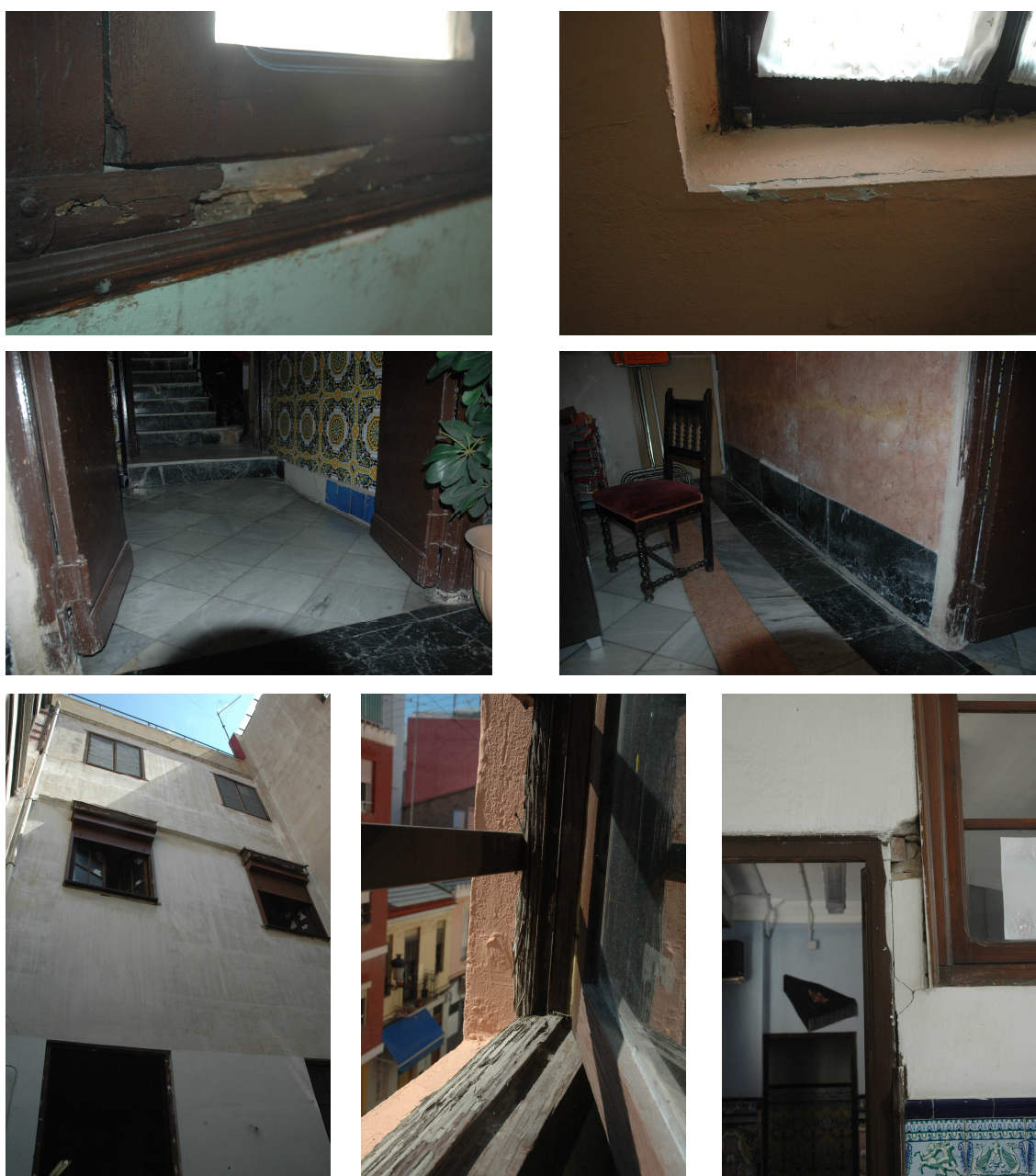
Imagen 72. Diversas lesiones en carpintería de madera del edificio. Fuente propia
