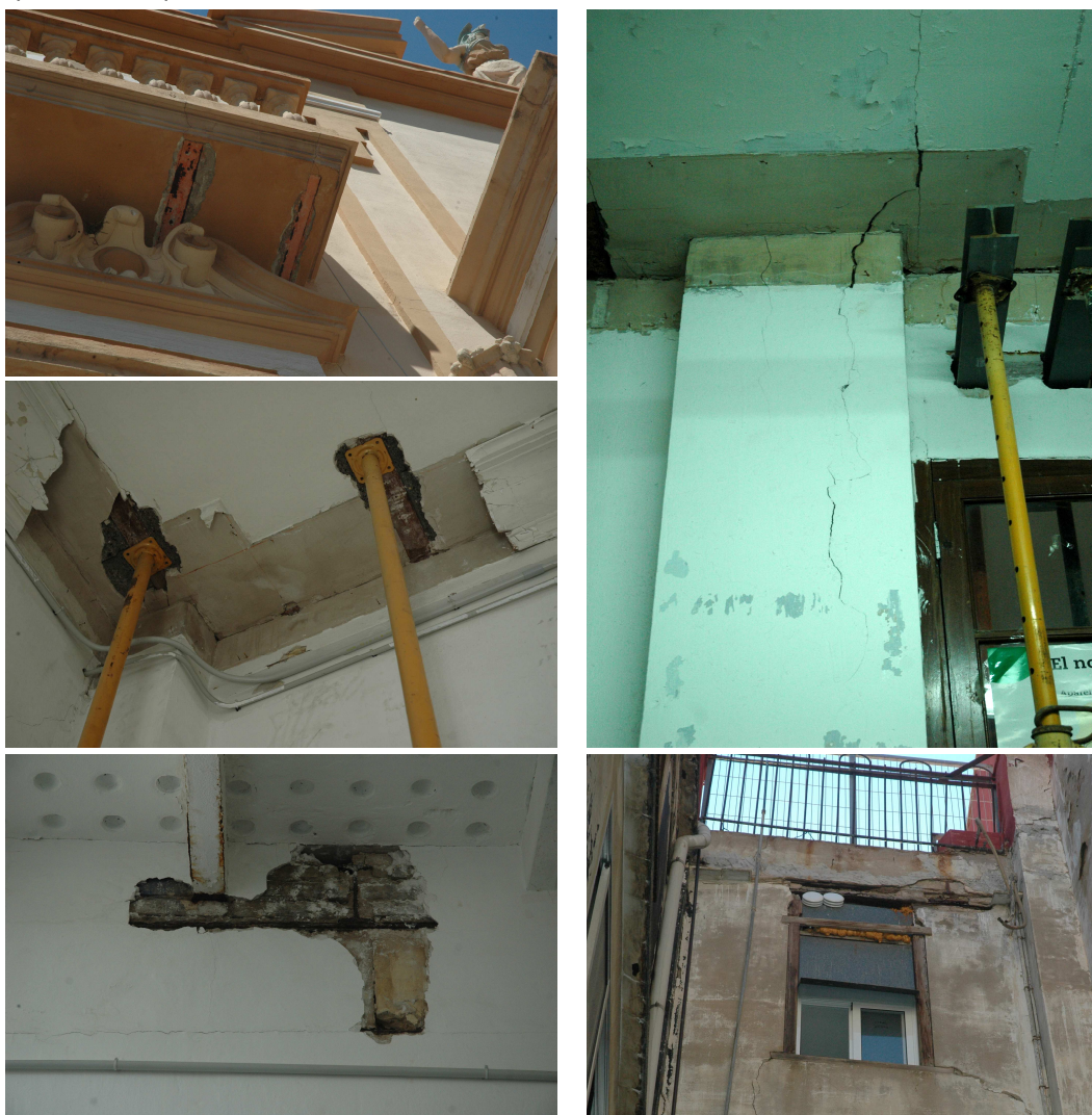
Imagen 69. Lesiones y apuntalamientos. Fuente propia
