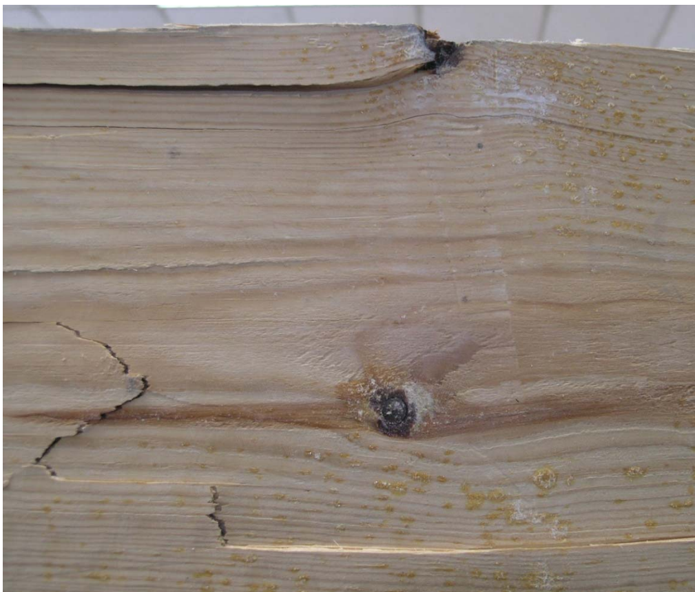
Figura 101. Detalle de rotura por nudo de canto de la viga PS2-37.
