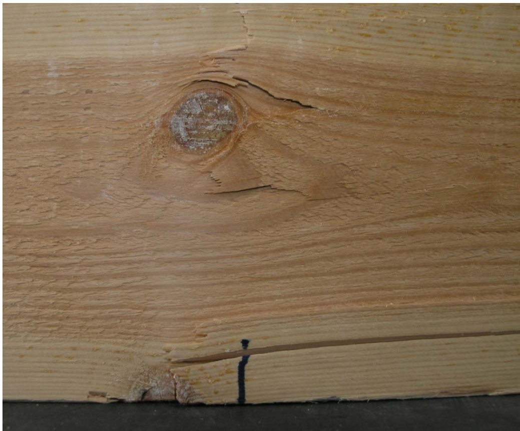
Figura 84. Detalle de rotura de la viga PS2-3.
