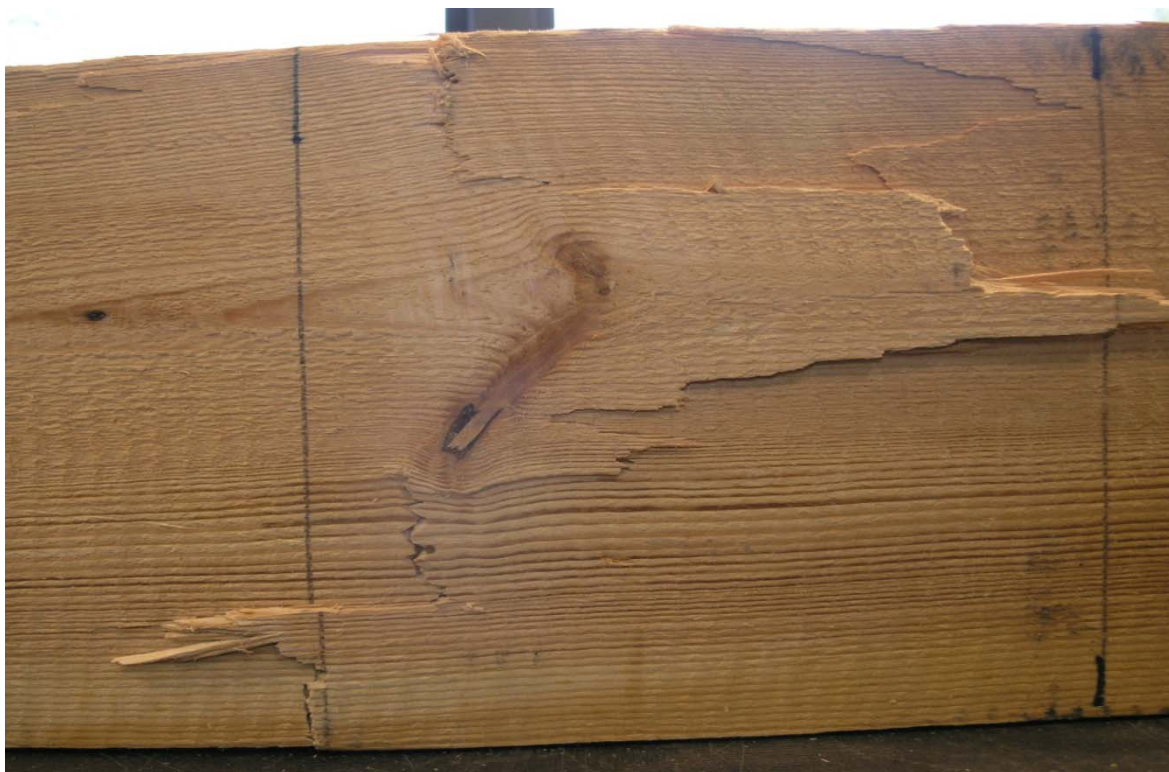
Figura 81. Detalle de rotura de la viga PS1-25.
