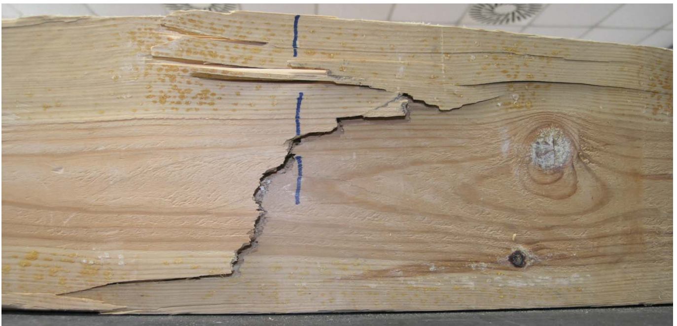
Figura 95. Detalle de rotura de la viga PS2-22.
