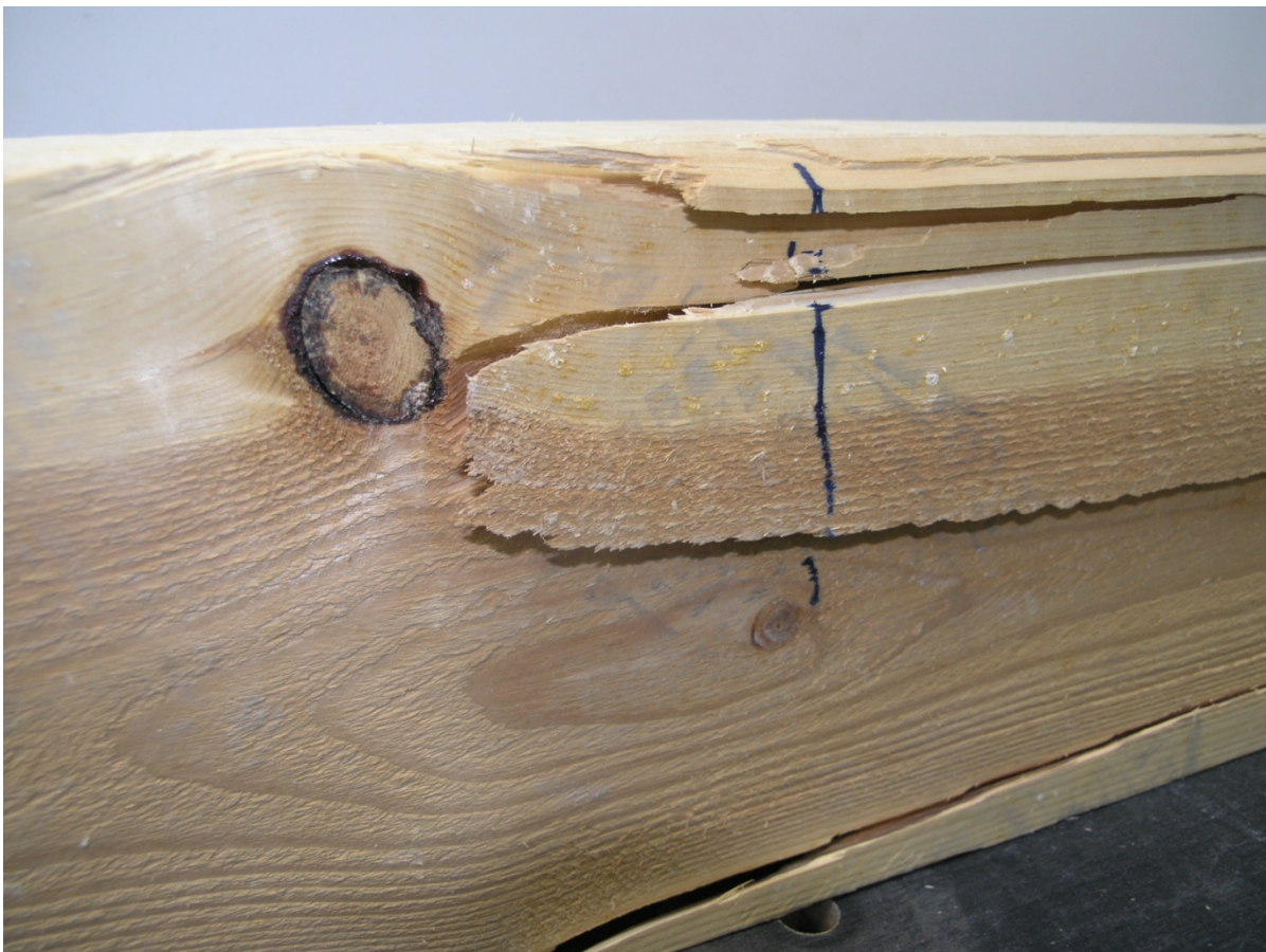
Figura 92. Detalle de rotura de la viga PS2-18.
