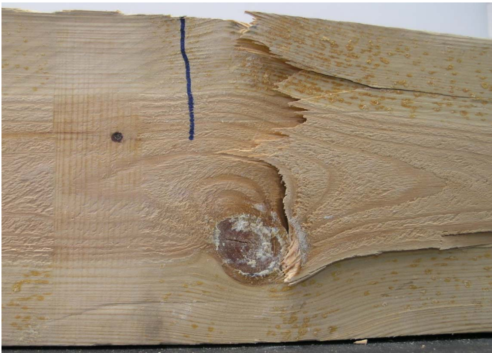
Figura 97. Detalle de rotura de la viga PS2-28.
