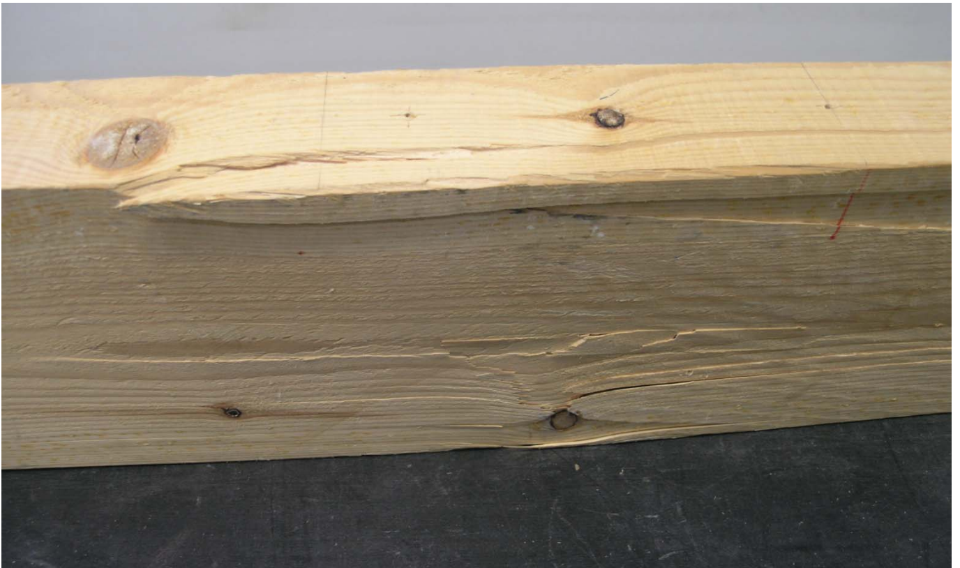
Figura 89. Detalle de rotura de la viga PS2-14.
