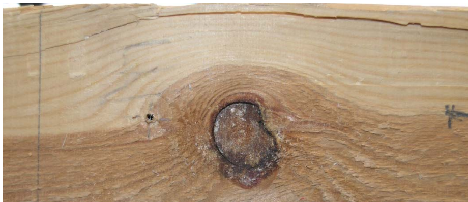
Figura 98. Detalle de rotura de la viga PS2-29.
