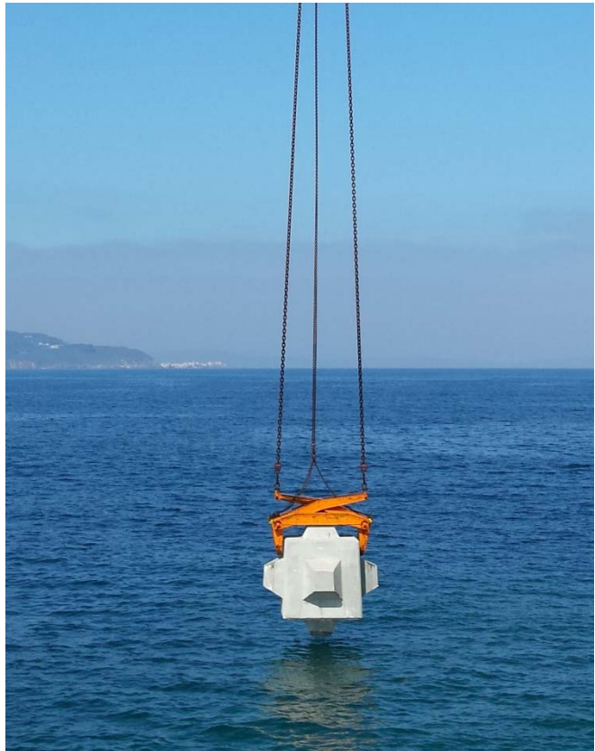
Colocación de un Cubípodo de 25 t con pinzas de presión en la construcción del Dique Oeste de Punta Langosteira (Puerto de A Coruña, julio de 2015)
