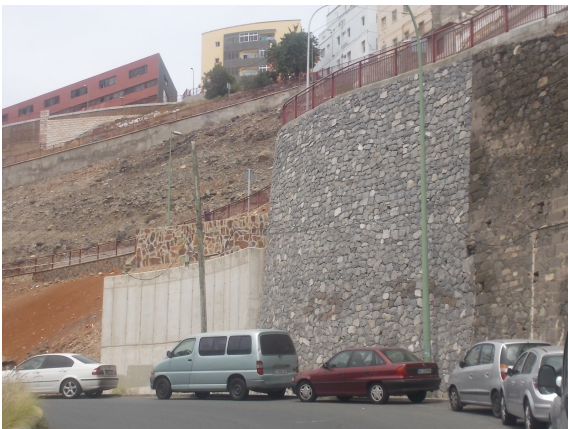
Figs. 133-134. Muro de contención de piedra seca en eras de Teno y muros de contención de la carretera la Mata ambas en Canarias, España
