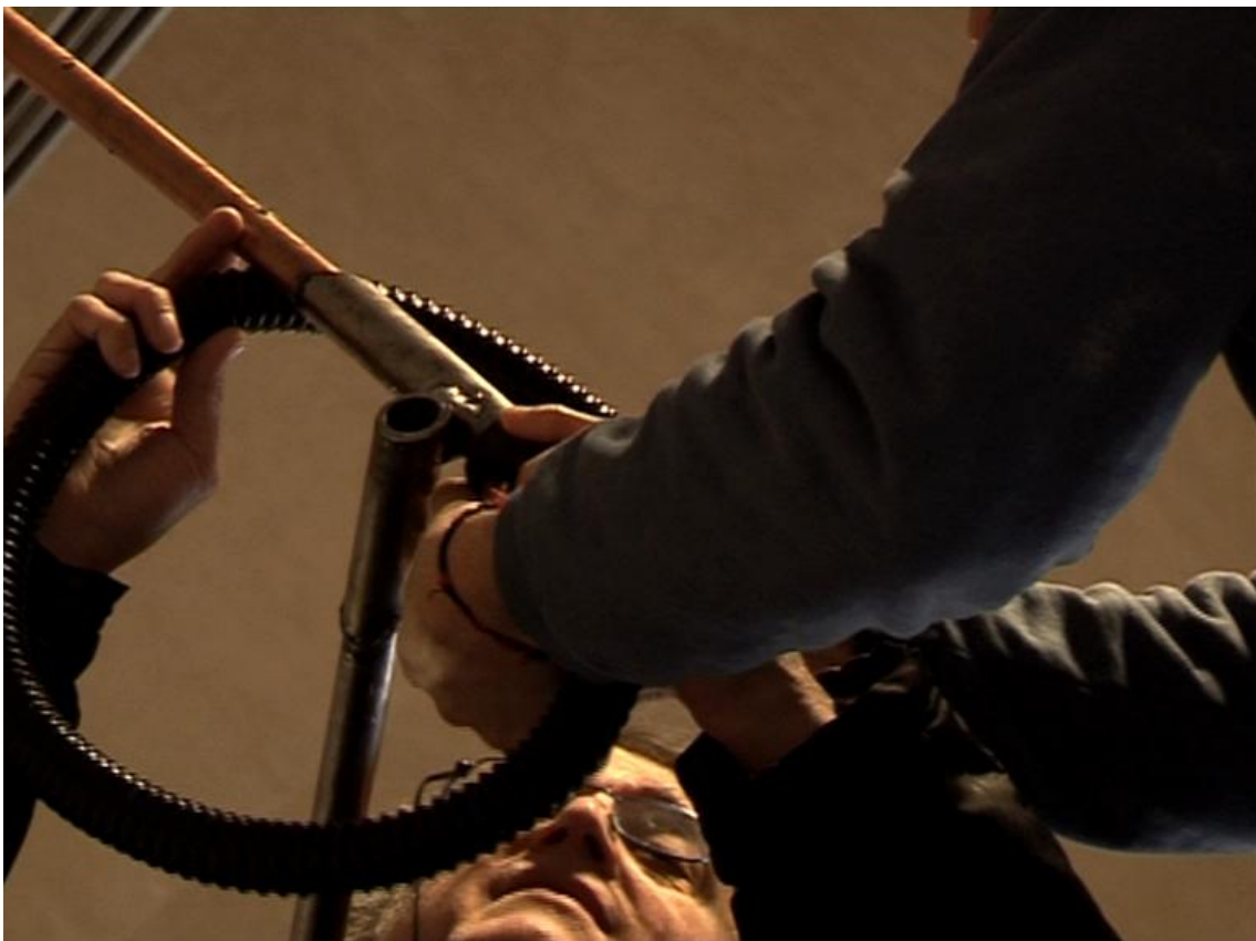
Ilustración 90: Zorio afirmando mediante cinta de caucho negra la barra de cobre y el tubo del compresor
