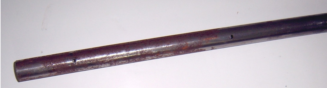
Ilustración 76: Oxidación del extremo de la barra
