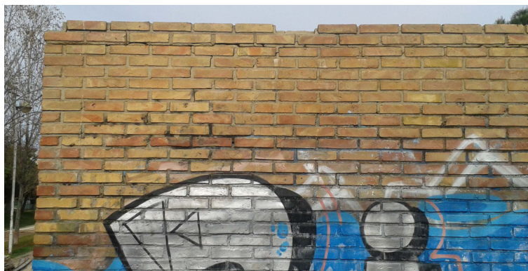
Por todo el perímetro de la parte superior de los muros puede observarse faltas de ladrillo y grietas.
