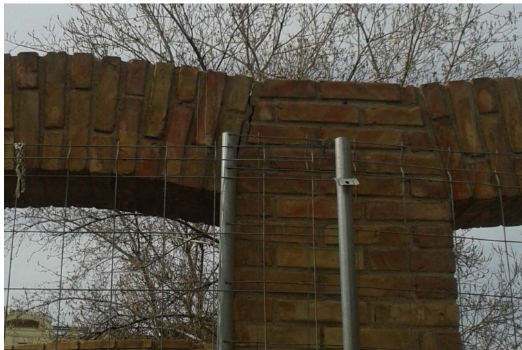
En la foto se puede apreciar las grietas en uno de sus arcos de la cara principal de la pieza.
