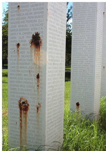
Imágenes en las que se puede apreciar la oxidación de las columnas con una mayor incidencia en la parte inferior del monumento.
