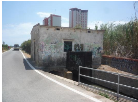
Antigua instalación de rebombeo (El Puig)
