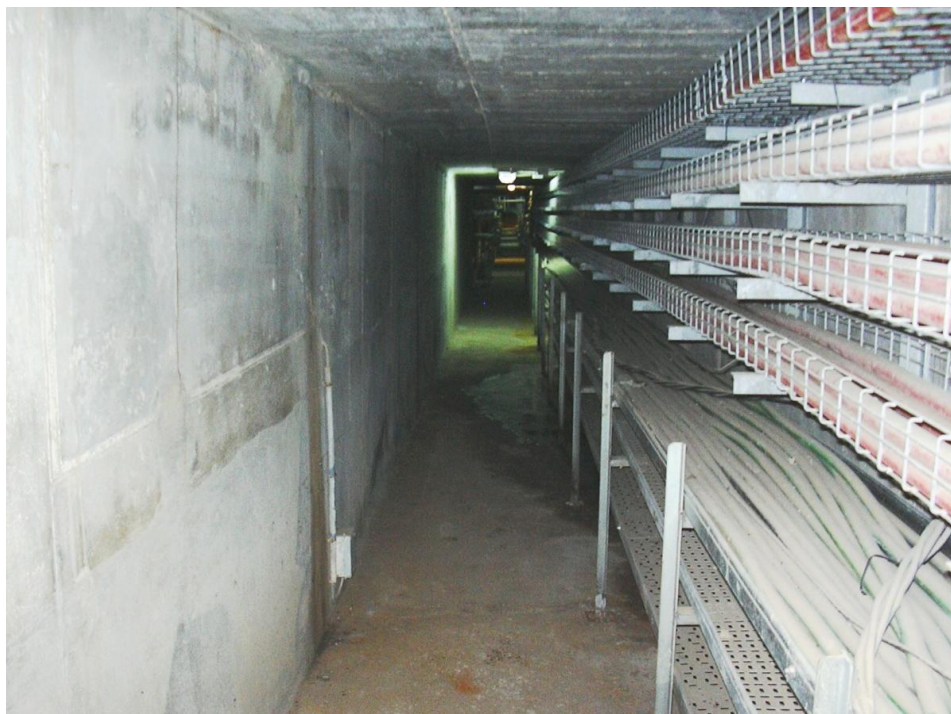
Imagen 7.- Líneas eléctricas en galería de servicio de la UPV.
