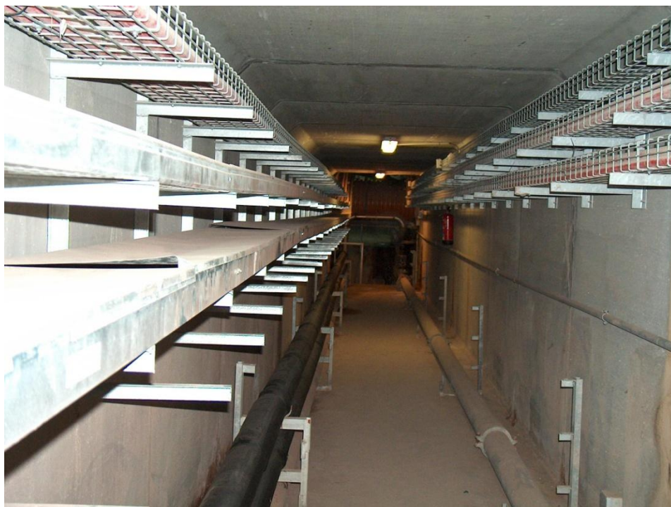
Imagen 1.- Galería de servicio visitable.
