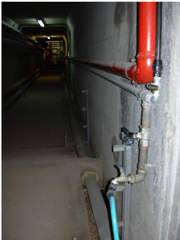
Imagen 5.- Sistema de agua de baldeo.
