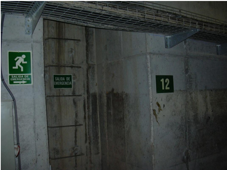
Imagen 2.- Salida de emergencia en galería de servicios.
