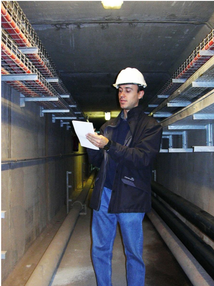
Imagen 6.- Espacio de trabajo en una galería de servicio visitable.
