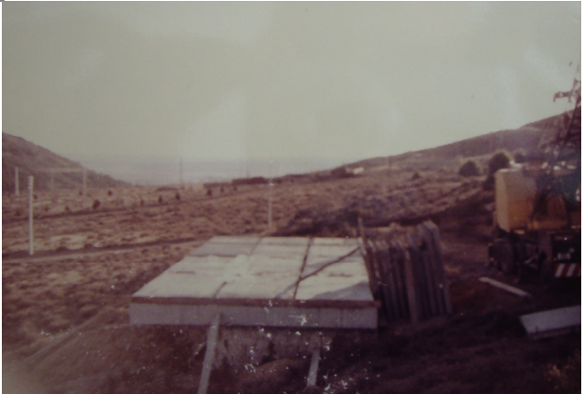
Serie de fotos del 2 al 10 de enero de 1965 con la elevación de los muros y disposición placas forjado Fotografía FCE 1 Fotografía FCE 6
