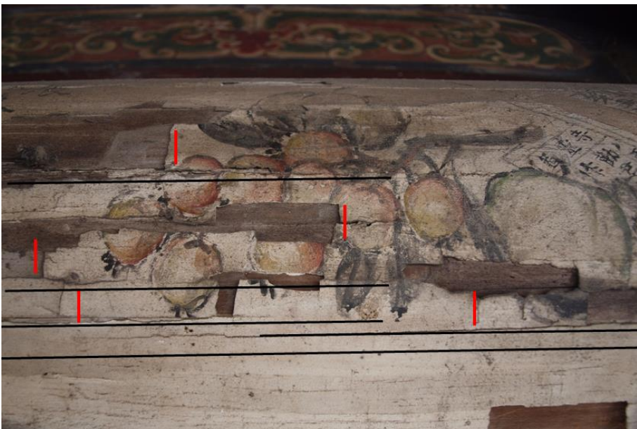
Figura 5.2.1.- Zona de la techumbre en el Escenario aquejada de grietas. Las líneas negras muestran la dirección del agrietamiento de la policromía que transcurre paralela a la veta de la madera. Las líneas rojas muestran el agrietamiento en sentido “transversal a la veta”.
