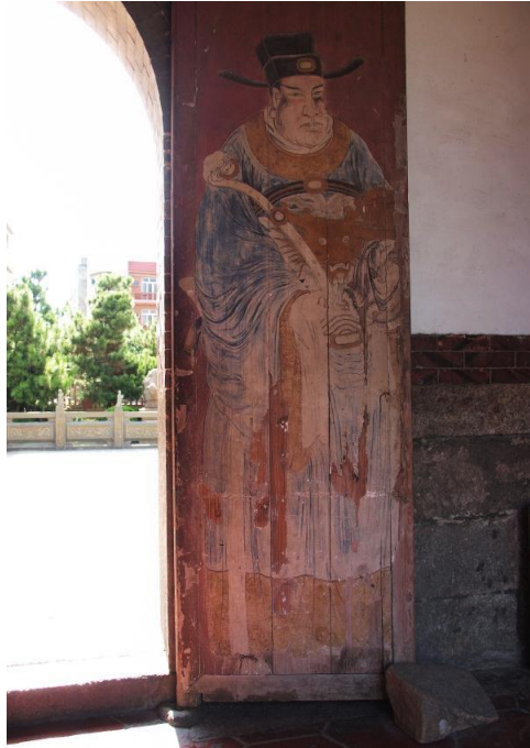
Figura 5.2.11.- Deterioro en la parte inferior y cantos de una de las puertas de entrada, con grandes pérdidas de materiales. También se observan grietas y separaciones.
