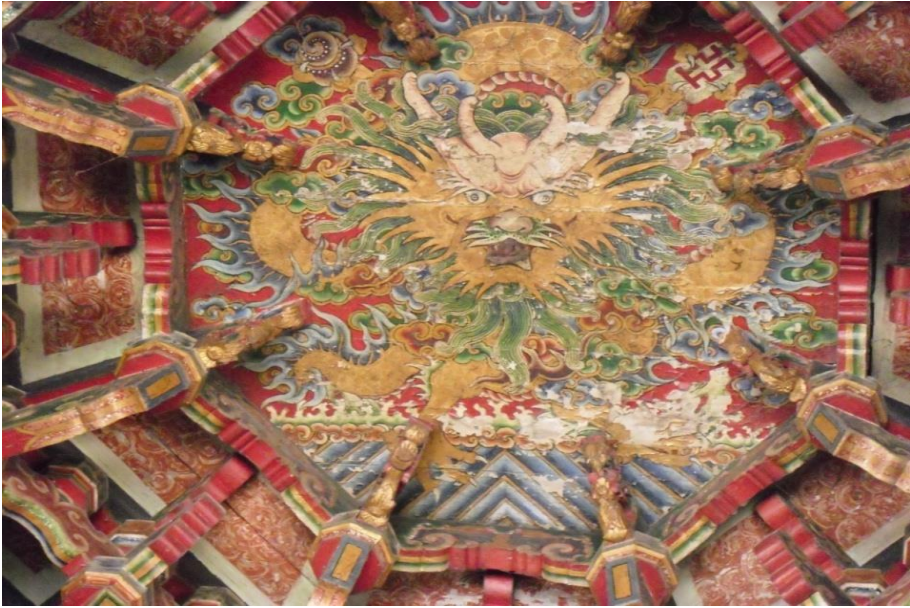
Figura 5.2.7.- Separación de la capa pictórica respecto de la preparación en la clave del Escenario.
