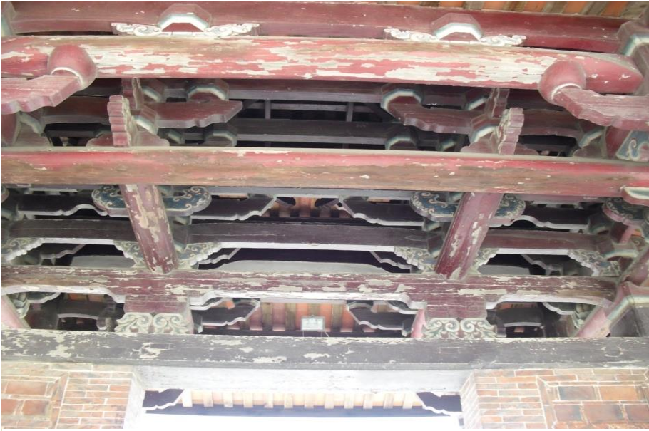
Figura 5.2.4.- Policromía con descamaciones y desprendimiento total o parcial del soporte de madera dando lugar a lagunas o faltantes de gran tamaño.
