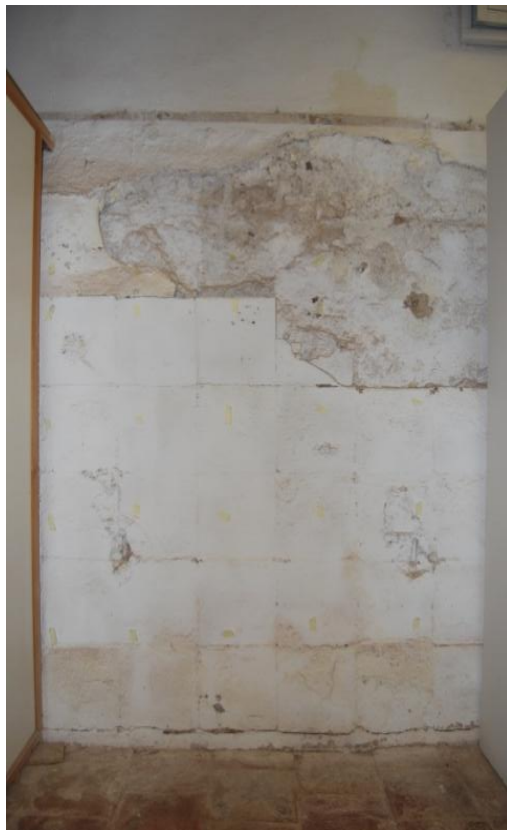
Ejemplos de humedad en los edificios_Fotografías de la autora
