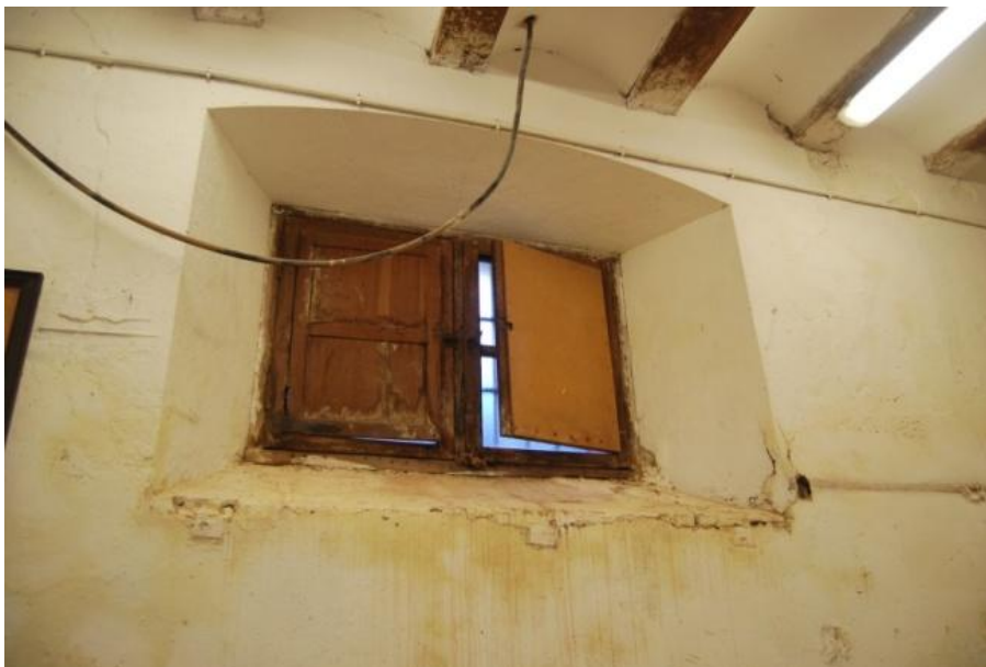
Ejemplos de humedad en los edificios_Fotografías de la autora
