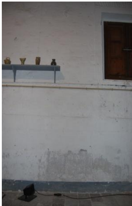
Ejemplos de humedad en los edificios_Fotografías de la autora
