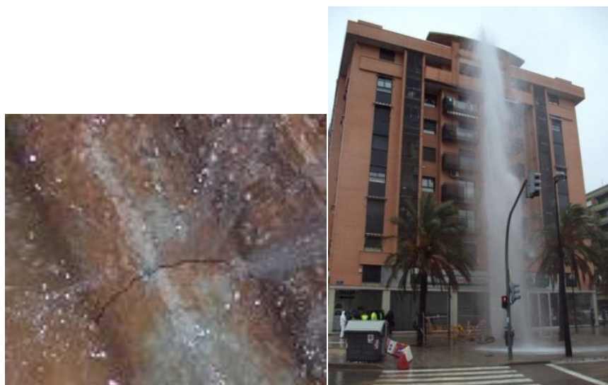
Fig. 9-3. Imágenes de fugas visibles
