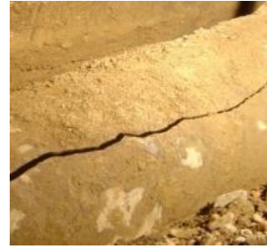
Fig. 9-6. Fisura en tubería
