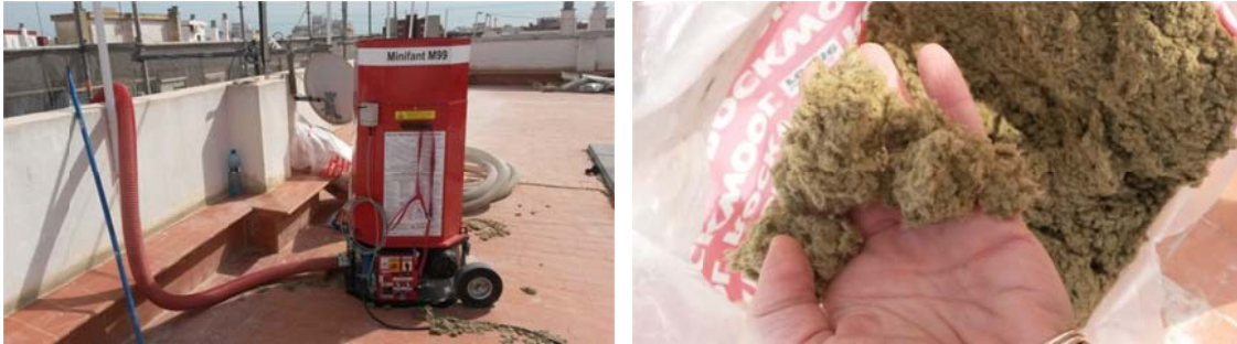
Imagen 44: Máquina en cubierta desde la que se insufla a todo el edificio, y muestra de los nódulos. Fuente IVE
