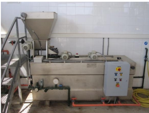
Ilustración 29.- Equipo de acondicionamiento químico de lodos.
