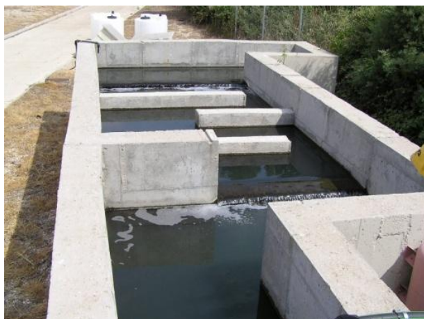
Ilustración 26.- Canal de Cloración.
