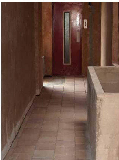
19, 20. Imagen de la rotura del pavimento de zonas comunes. Fotografía de septiembre de 2004
