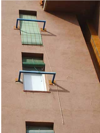
17, 18. Imágenes de las patologías en las cerrajerías y anclajes metálicos. Fotografías de enero de 2006
