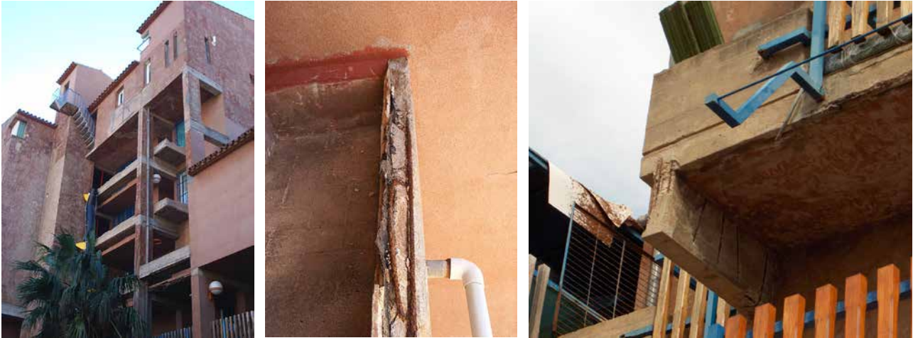
12, 13. Imágenes del deterioro de los elementos de hormigón expuesto hasta descubrir las armaduras. Fotografías del 19 de enero de 2006
