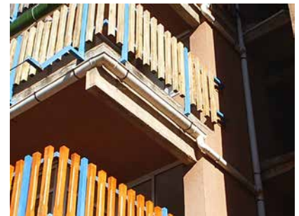
21, 22. Imágenes de los barrotes de madera dañados por el sol y el ambiente marino. Fotografía de enero de 2006
