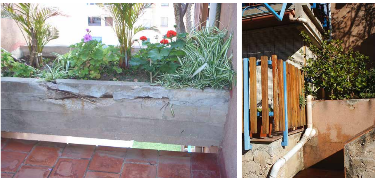
16. Imagen de las patologías aparecidas en las jardineras de hormigón. Fotografía de enero de 2006
