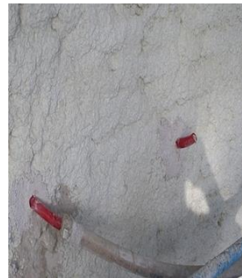
Fig. 109. Boquillas para inyectores de lechada de cal. Lorca.
