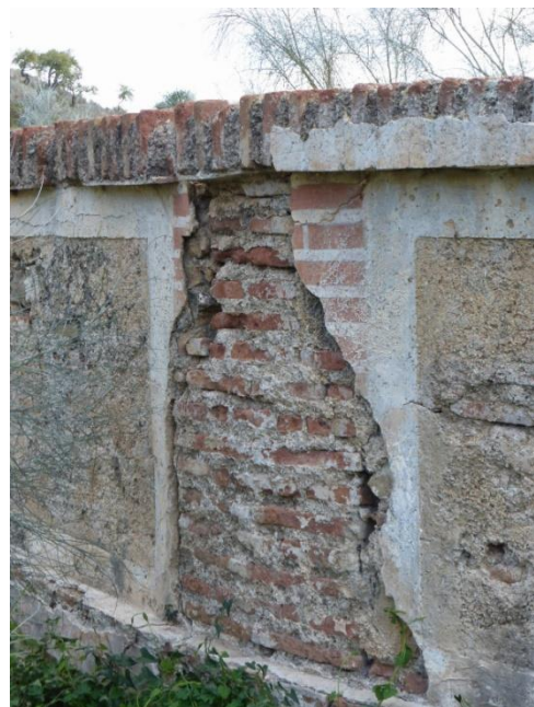
Fig. 138. Fingido de ladrillos sobre muro de ladrillo. Acueducto de San Telmo, Sevilla. Se trata de un elemento B.I.C.
