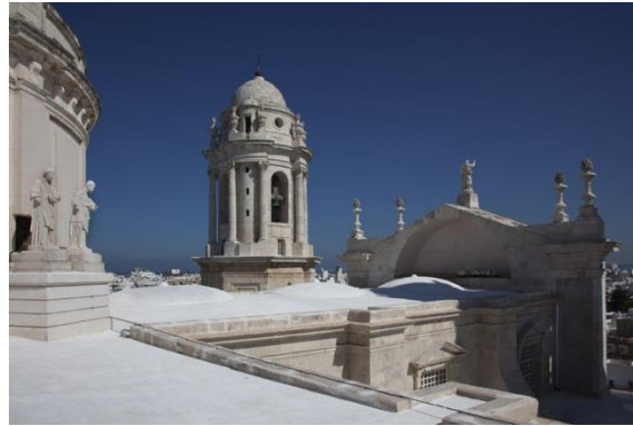
Fig. 108. Cubierta de la catedral de Cádiz rehabilitada con Pintura de cal y Grafeno.
