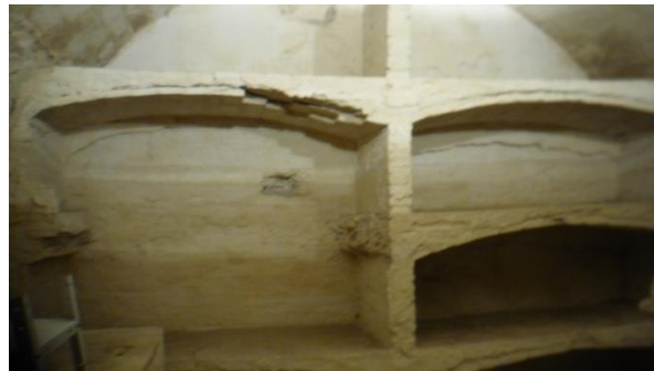
Fig. 104. Cripta de las Escuelas Pías tratada mediante agua de cal.
