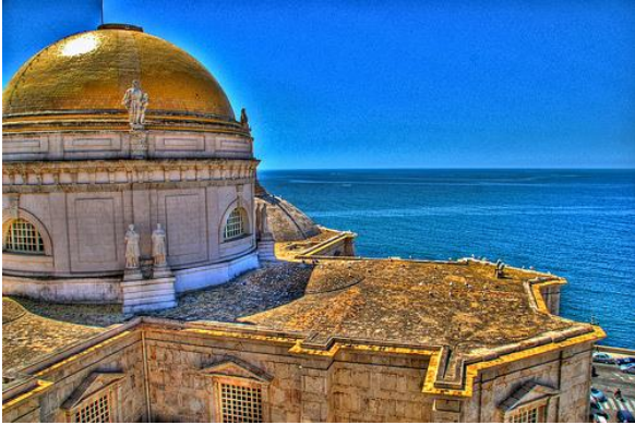
Fig. 102. Cubierta de la catedral de Cádiz, antes de su rehabilitación.
