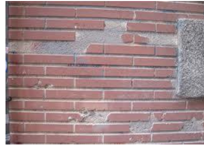
Fig. 140. Detalle de fingido de ladrillos, los cuales de están desprendiendo.
