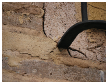
5.31. Rotura del vierteaguas (izquierda).
