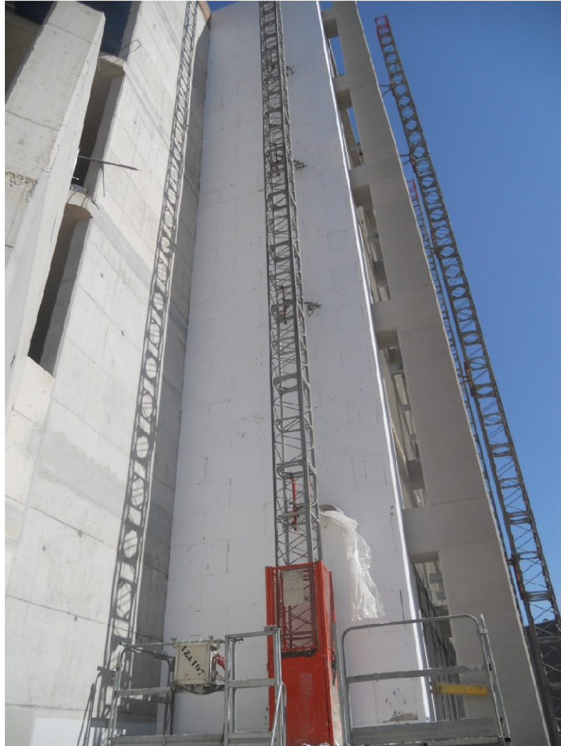
Andamio mono-mástil en Fachada Oeste 1
