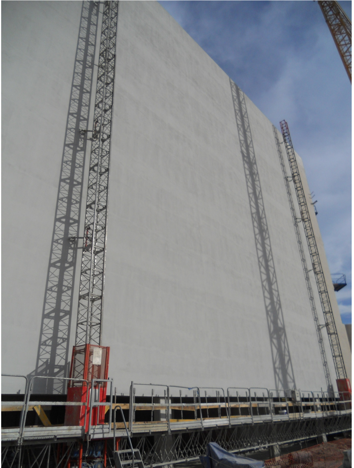
Detalle del andamio bi-mástil de cremallera instalado en la fachada Oeste. B3
