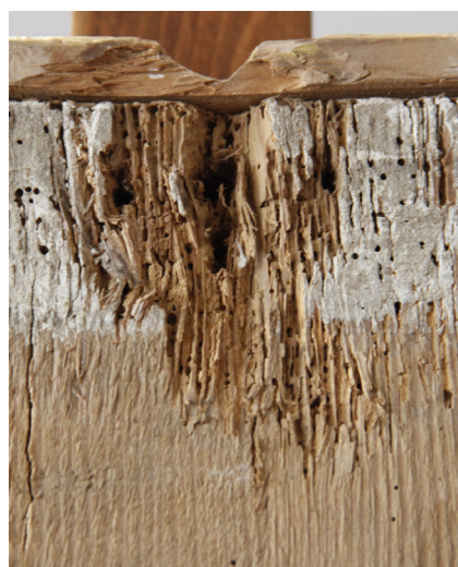
Fig.14 Detalle de la rotura y daños por insectos xilófagos ( Santa Ana ).
