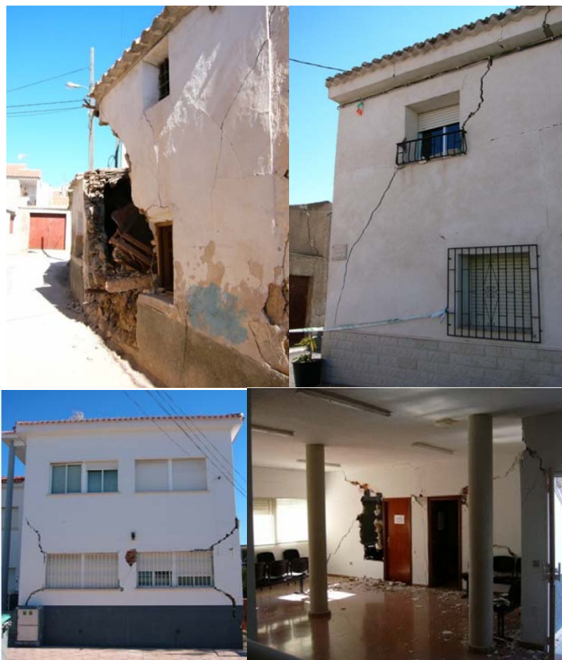
Figura 1.5. Terremoto de Bullas (Murcia, España), del 29 de enero de 2005, M_w=4,8 . Se observa el fallo de los muros de carga de edificios de mampostería (arriba izquierda), daños por cortante en fachadas (arriba derecha) y en edificios modernos construidos con pórticos de hormigón (abajo izquierda). Se observaron graves daños en la tabiquería (abajo derecha). Fuente: IGN
