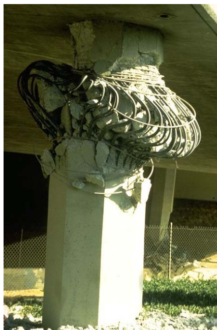
Figura 1.7. Plastificación del pilar de un puente en el terremoto de Northridge (California, EUA), del 17 de enero de 1994, M_w=6,7 .
