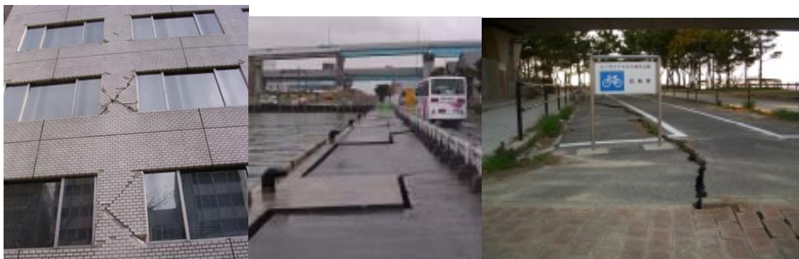
Figura 1.4. Efectos del Terremoto de Kyushu (Japón), del 20 de marzo de 2005, M_w=6,3 en la ciudad de Fukuoka. Se aprecian los daños en los edificios por esfuerzo de cortante y los corrimientos de tierras que provocan grietas en aceras, carreteras y muelles de los puertos. No hubo que lamentar ninguna víctima a pesar de la severidad del terremoto.
