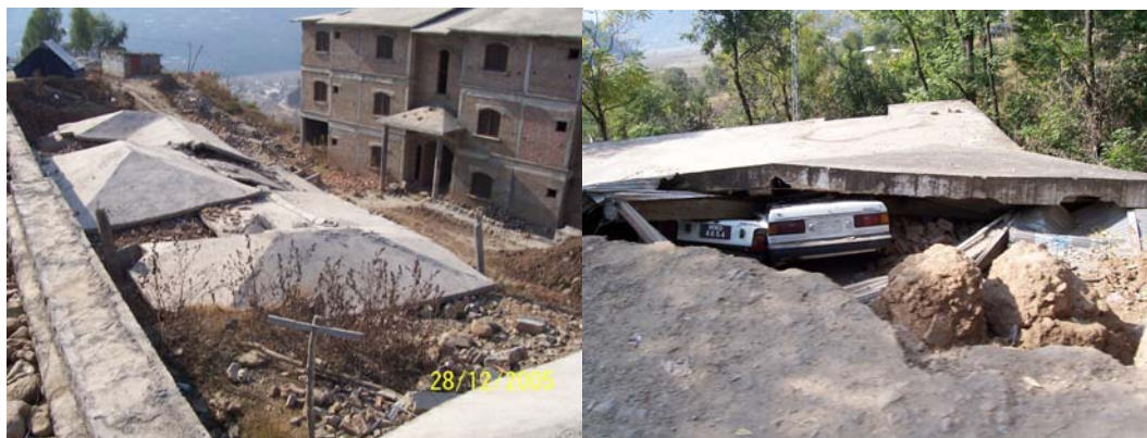
Figura 1.3. Terremoto de Pakistán, del 8 de octubre de 2005, M_w=7,6 . Se aprecian los daños en los edificios. Izquierda: Colapso de estructura de pórticos de hormigón. Los tejados han caído sobre la estructura colapsada. Derecha: colapso de estructura de hormigón. Hubo más de 80.000 víctimas mortales. Fotos cedidas al autor por Ignacio Albiñana.
