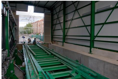
Foto 4. Cambio automático de ancho. Fuente: ADIF.
