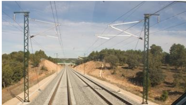
Foto 14. Catenaria. Fuente: ADIF.
