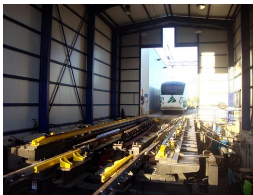
Foto 5. Cambio automático de ancho. Fuente: ADIF.
