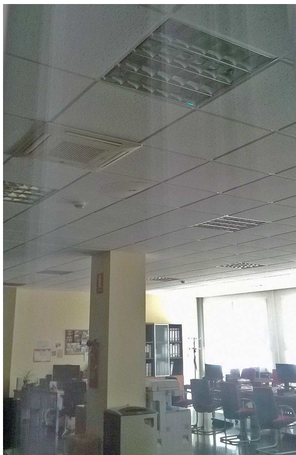
Figura 61. Luminarias empotradas en secretaría. Edificio 1G. Fuente: Propia.
