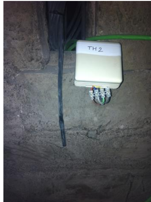
Figura 5.44. Sensor TH2 de T a -HR, pasillo trasdós bóveda.
