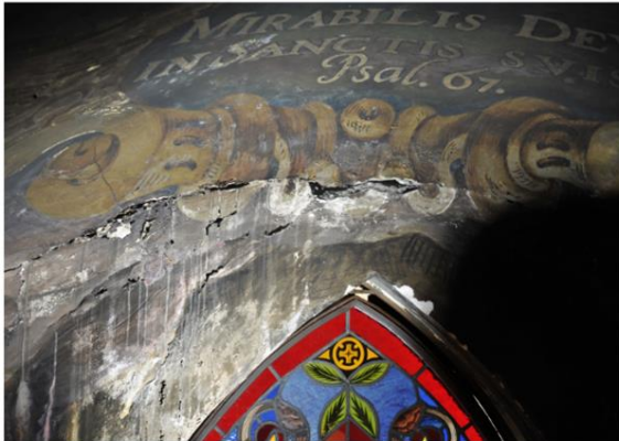
Figura 5.15 .Grieta entre muro y plementería del luneto 6.
