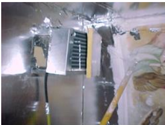
Figura 4.62. Visión de parte del aislamiento térmico y sistema de climatización.
