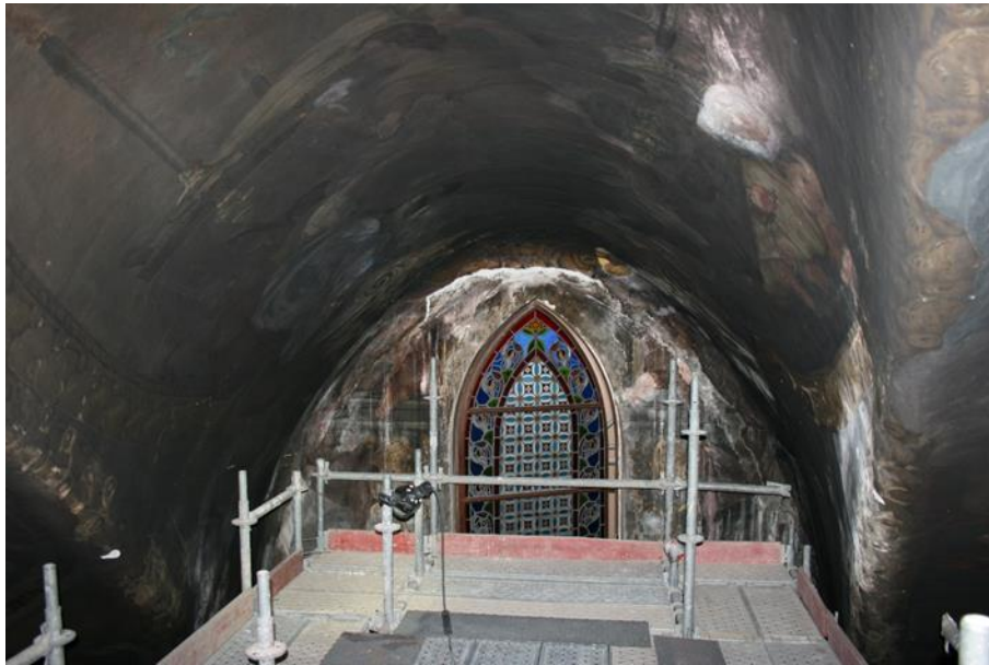
Figura 5.11. Filtraciones de agua por grietas, capilaridad descendente y lateral en los lunetos. Iglesia de San Nicolás.
