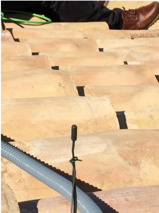
Figura 5.33. Sensor de Tª ambiente sobre cubierta exterior. T2.
