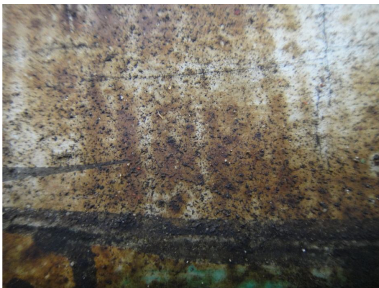
Figura 129. Acumulación de suciedad y de hollín provocado por la quema de incienso.
