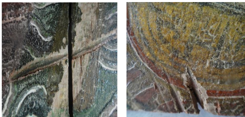
Figura 179. Daños en la puerta causados por el uso.
