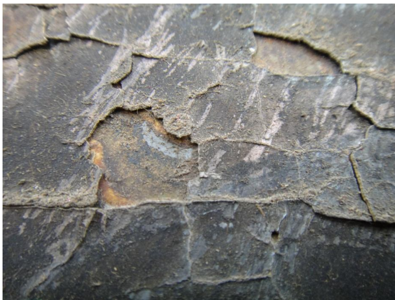
Figura 128. Detalle de las grietas, desprendimientos y acumulación de suciedad.
