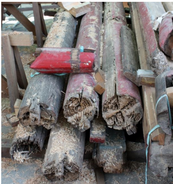
Figura 234. Daños por termitas en los pilares del templo de Tianhou en Qishan (Kaohsiung) (高雄旗山天后宮).
