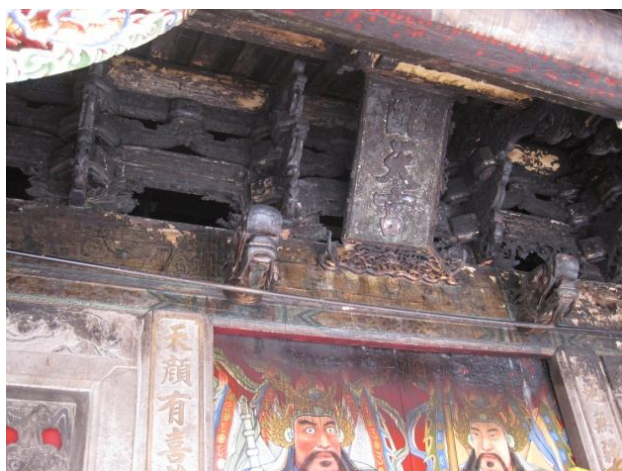
Figura 115. Estado del templo después del incendio. 218
