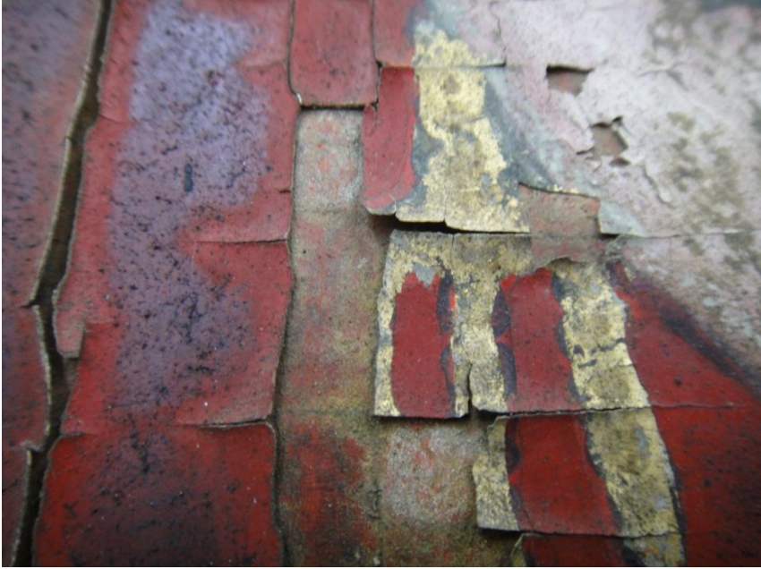
Figura 124. Pérdida de adherencia de la pintura.
