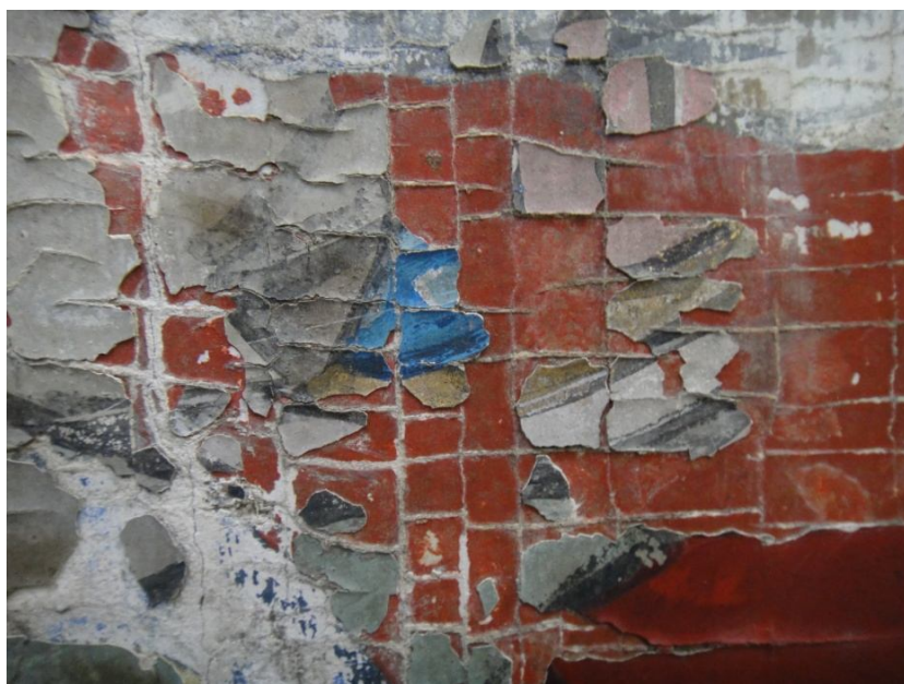
Figura 123. Cuarteado de la estructura pictórica más antigua y desprendimientos en la pintura de Cai Cao-Ru, más reciente.
