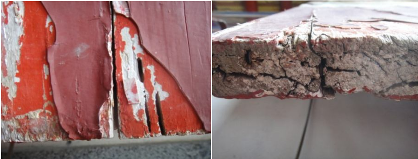
Figura 69. Daños en el soporte: grietas y ataque de insectos xilófagos.
