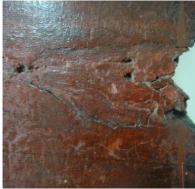
Figura 175. Daños causados por los nudos.
