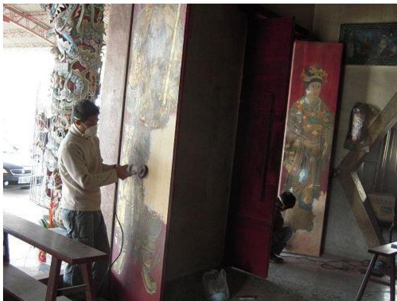
Figura 229. Eliminación de las pinturas antiguas para proceder a la realización de las nuevas. 355
