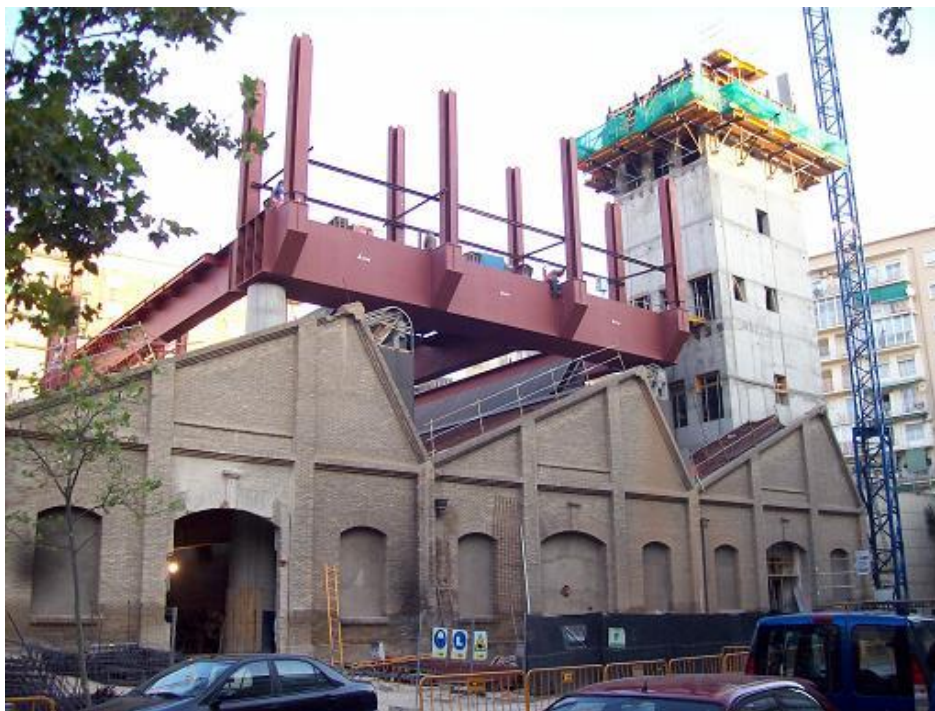
Edificio original de los talleres del Pablo Serrano con la estructura añadida sobre la que se construyó la ampliación posterior. 229
